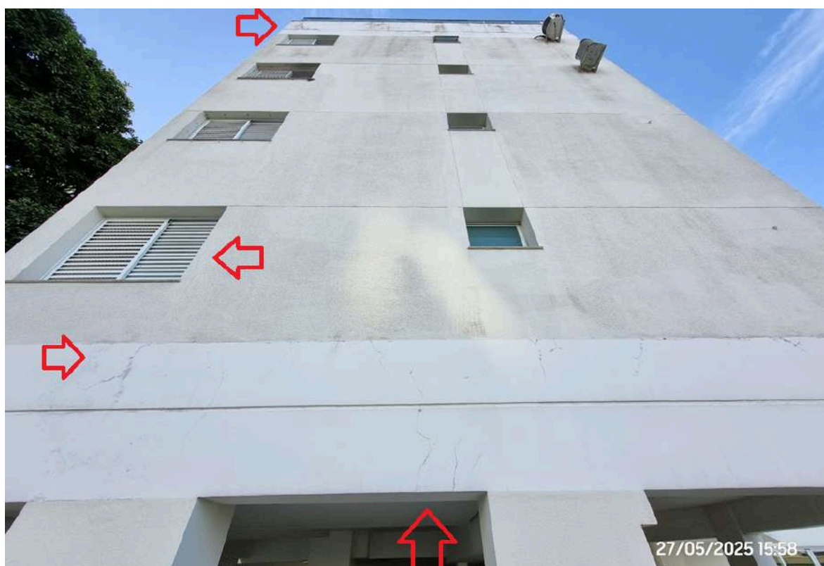
Imagem 083 - Fissura/trinca/rachadura e mofo na fachada lateral esquerda (parte fundos)
