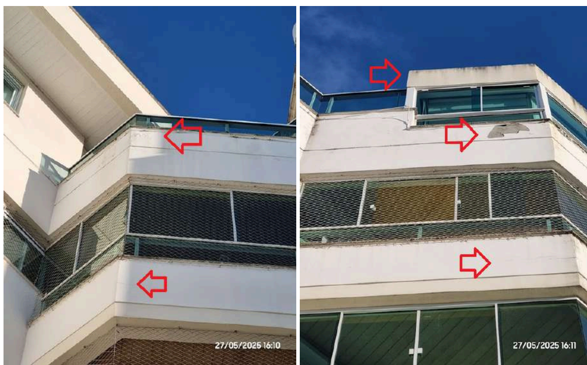
Imagens 093 e 094 - Fissura/trinca/rachadura, mofo e empolamento/deslocamento de revestimento na fachada lateral direita (parte dos fundos)
