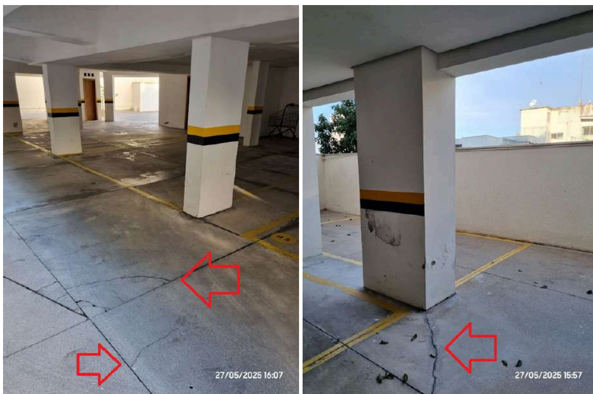
Imagens 103 e 104 - Fissuras/trincas/rachaduras no contrapiso do pavimento térreo (garagem)
