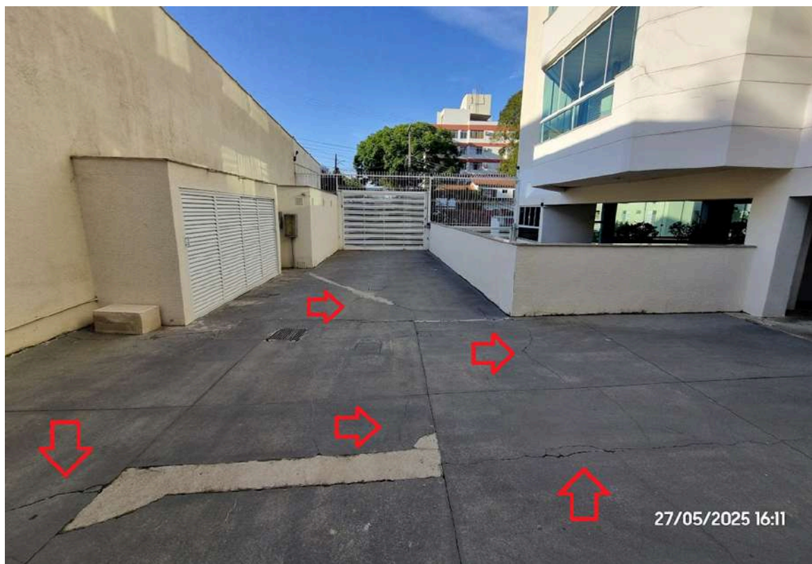
Imagem 105 - Fissuras/trincas/rachaduras no contrapiso do pavimento térreo (área de manobra)
