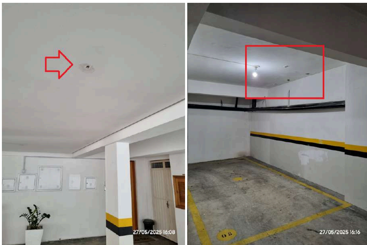
Imagens 042 e 043 - Mofo no forro de gesso na garagem térrea (à direita) e empolamento/desplacamento do revestimento na laje da garagem subsolo (à esquerda)
