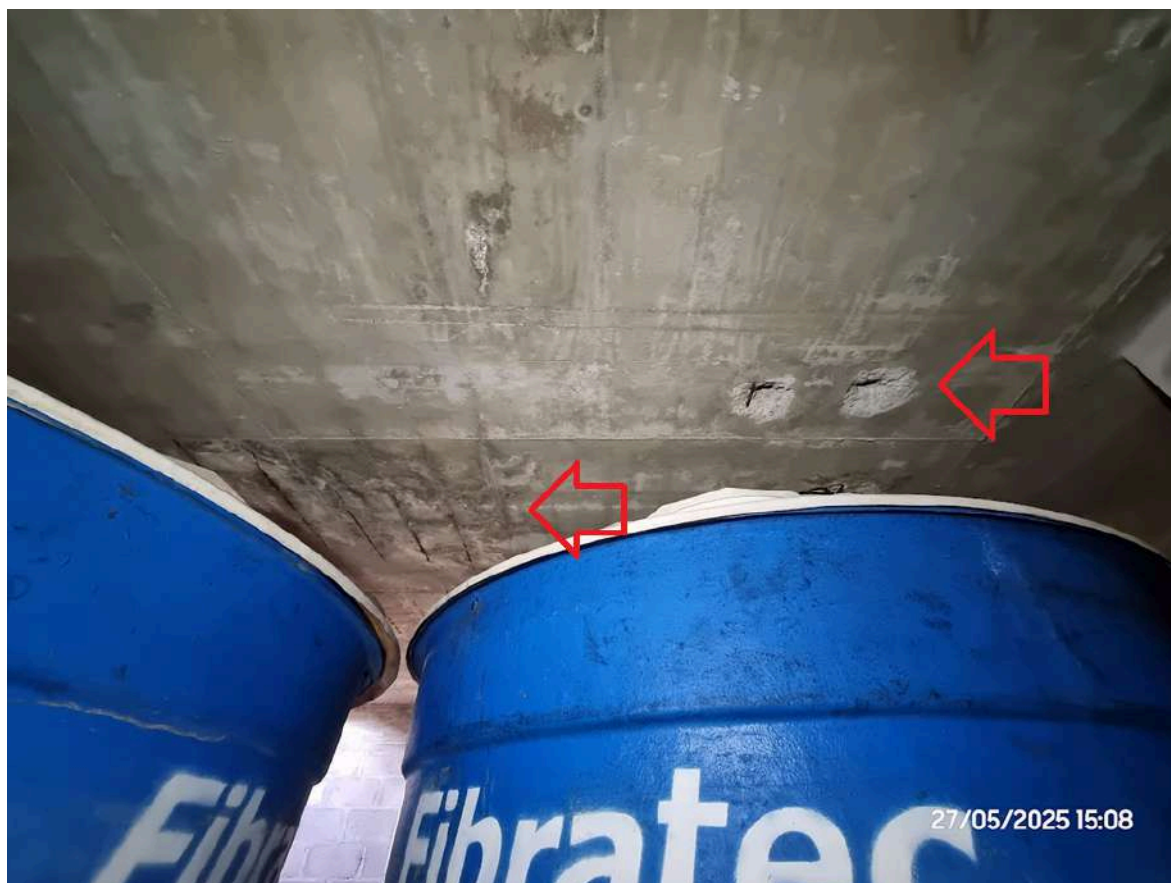
Imagem 005 - Corrosão de armadura na laje do reservatório superior
