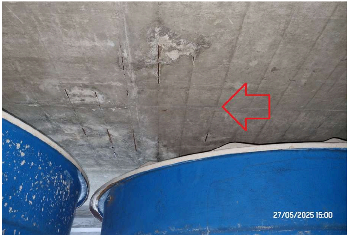
Imagem 006 - Corrosão de armadura na laje do reservatório superior
