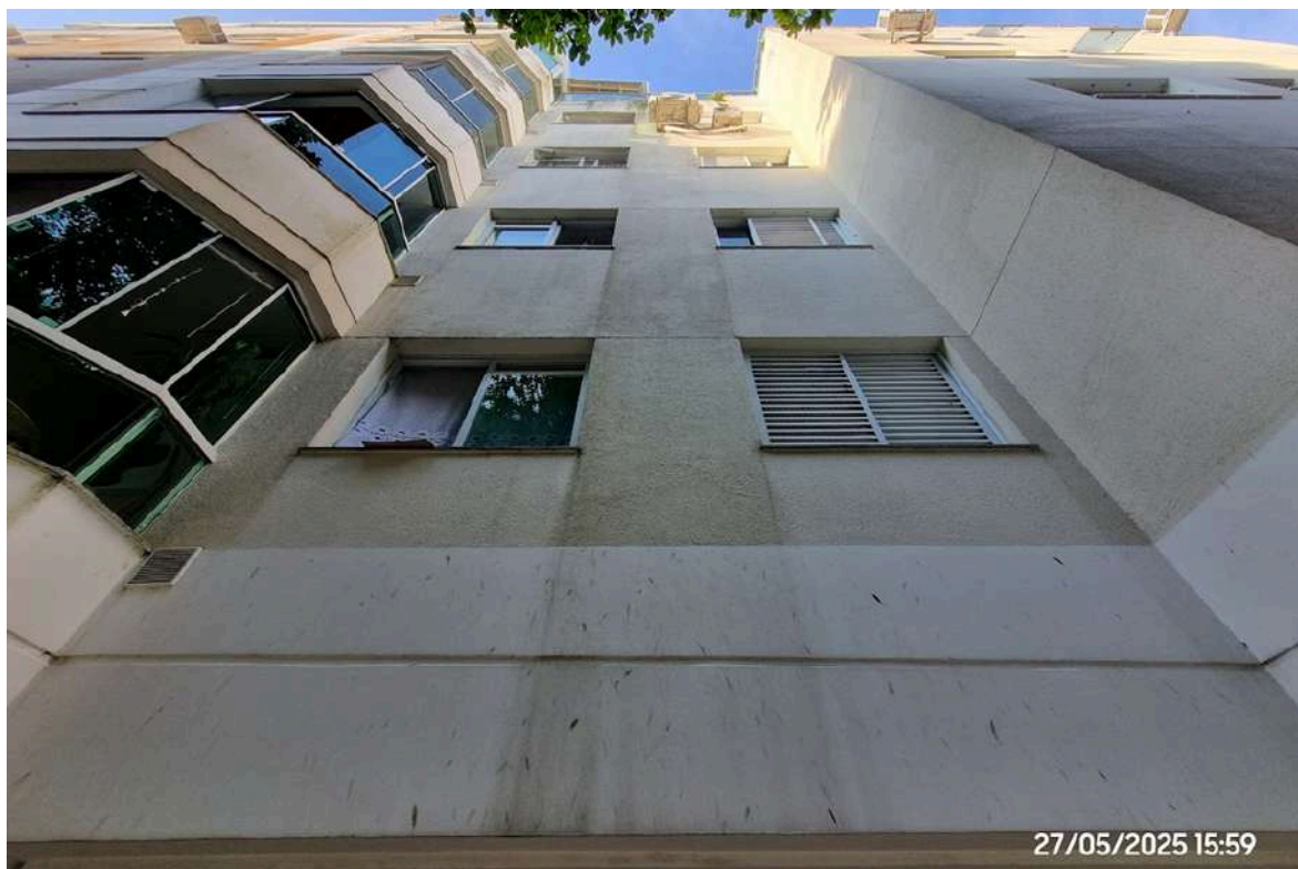
Imagem 087 - Fissura/trinca/rachadura e mofo na fachada fundos (parte central)
