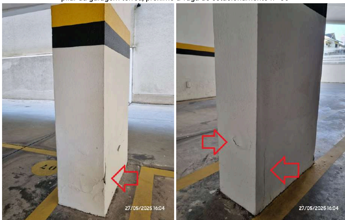
Imagens 067 e 068 - Fissura/trinca/rachadura e empolamento/deslocamento do revestimento de pilar da garagem térrea, próximo à vaga de estacionamento nº 07
