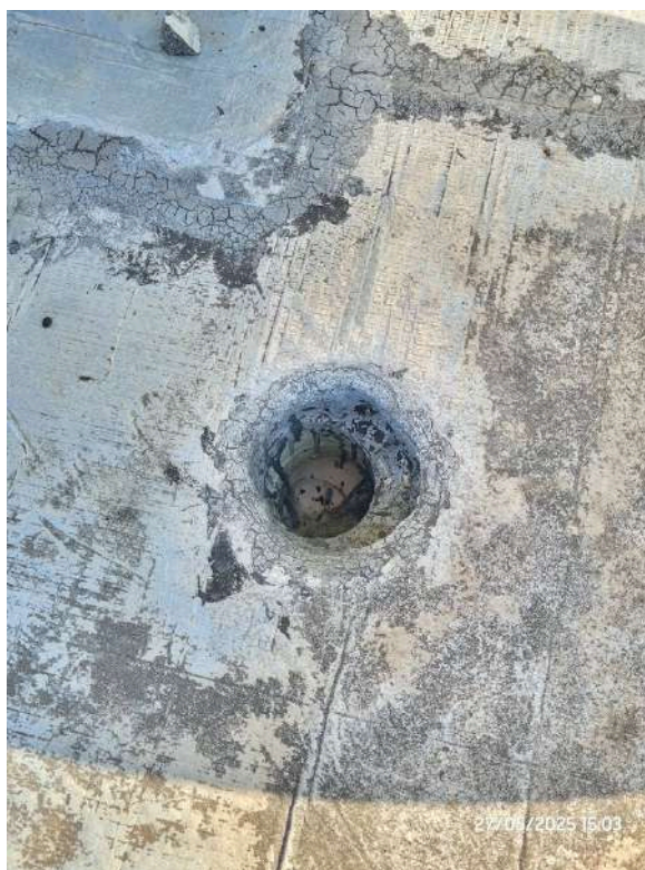
Imagem 003 - Ausência de ralo do tipo “abacaxi”
