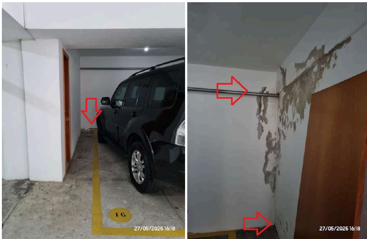
Imagens 036 e 037 - Empolamento/deslocamento e mofo no revestimento em parede da garagem subsolo (entornos da vaga 16)
