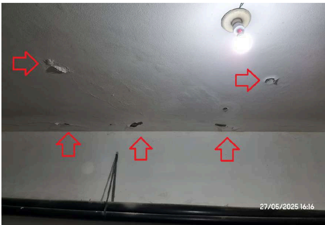
Imagem 044 - Detalhe empolamento/desplacamento do revestimento na laje da garagem subsolo
