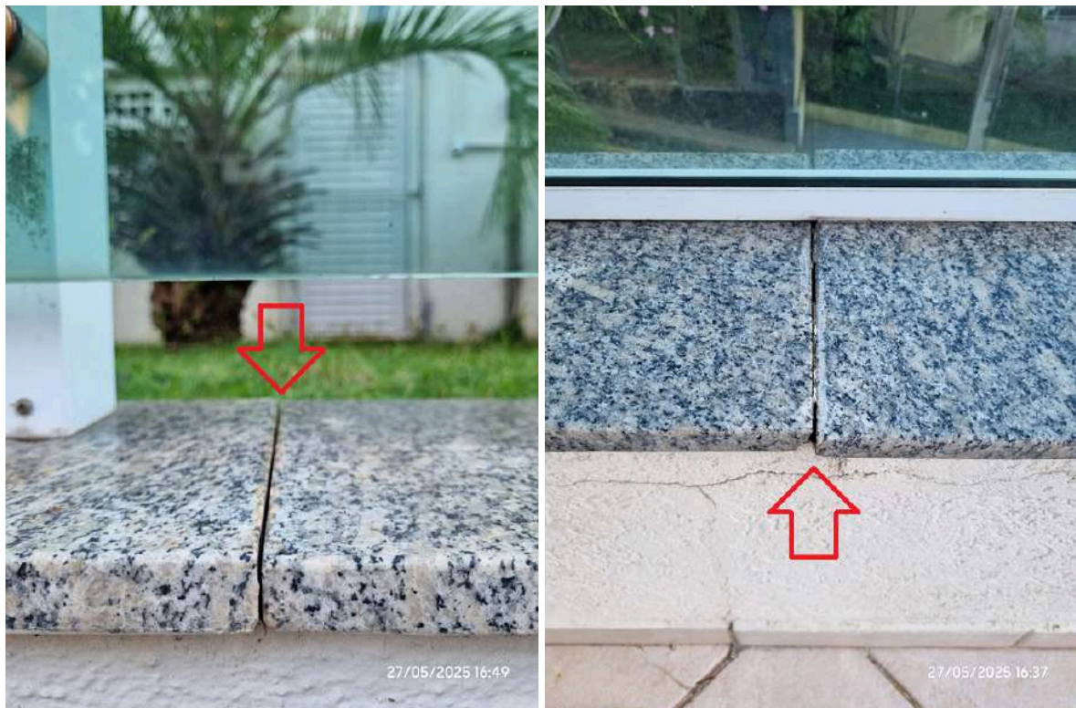
Imagens 110 e 111 - Ausência/deficiência de vedação em pingadeiras de muros
