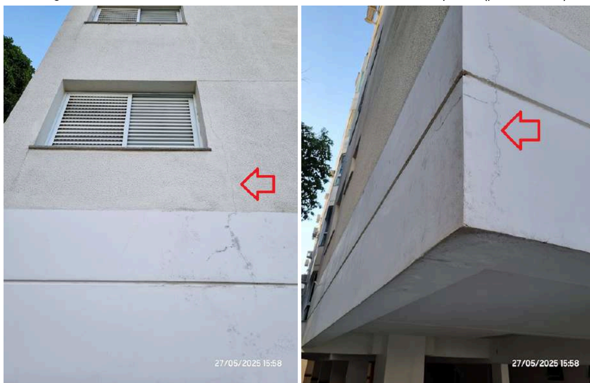
Imagens 084 e 085 - Fissura/trinca/rachadura e mofo na fachada lateral esquerda (parte fundos)
