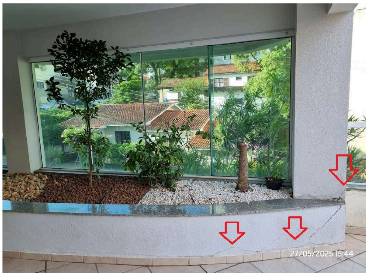
Imagem 050 - Fissuras/trincas/rachaduras no ambiente área de lazer coberta
