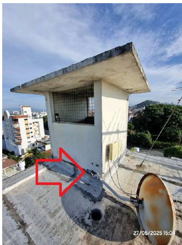
Imagem 004 - Antena desafixada na cobertura
