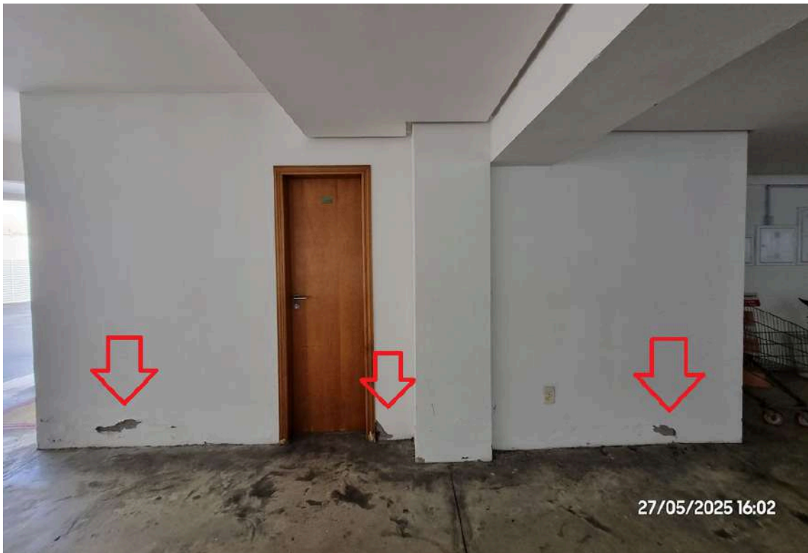
Imagem 022 - Empolamento/desplacamento do revestimento em parede da garagem térrea (próximo aos hobby-box 07 e 09)
