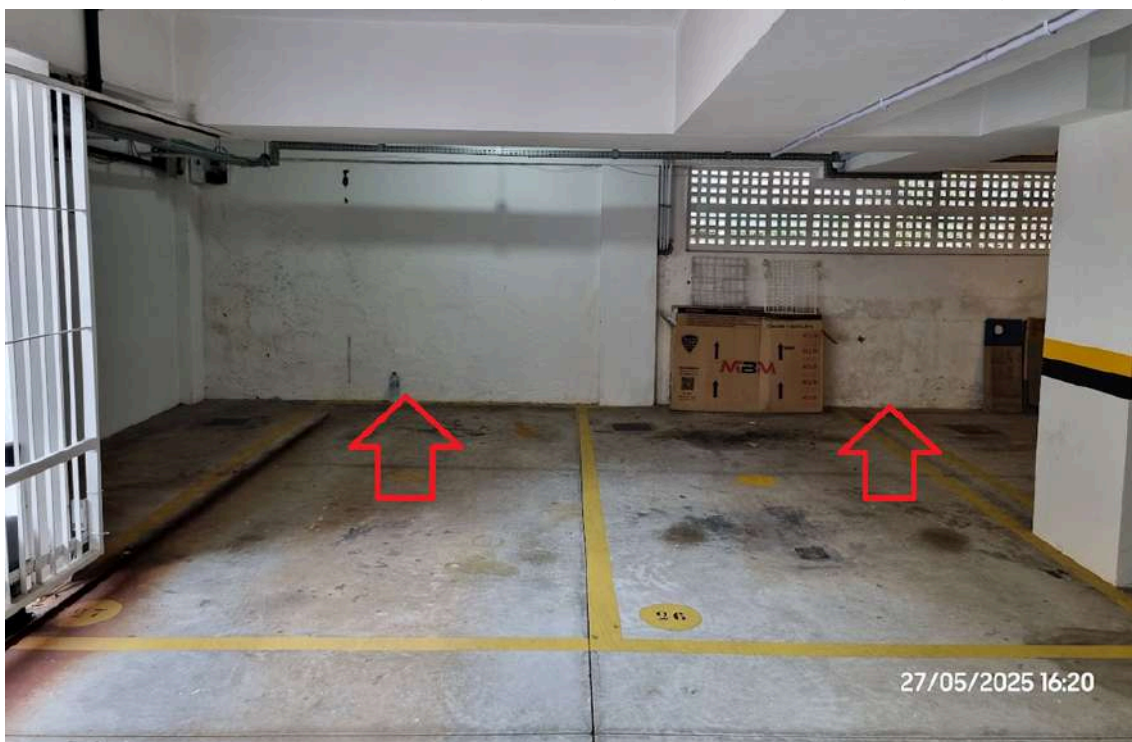
Imagem 028 - Empolamento e mofo no revestimento em parede da garagem subsolo (parede da fachada frontal)
