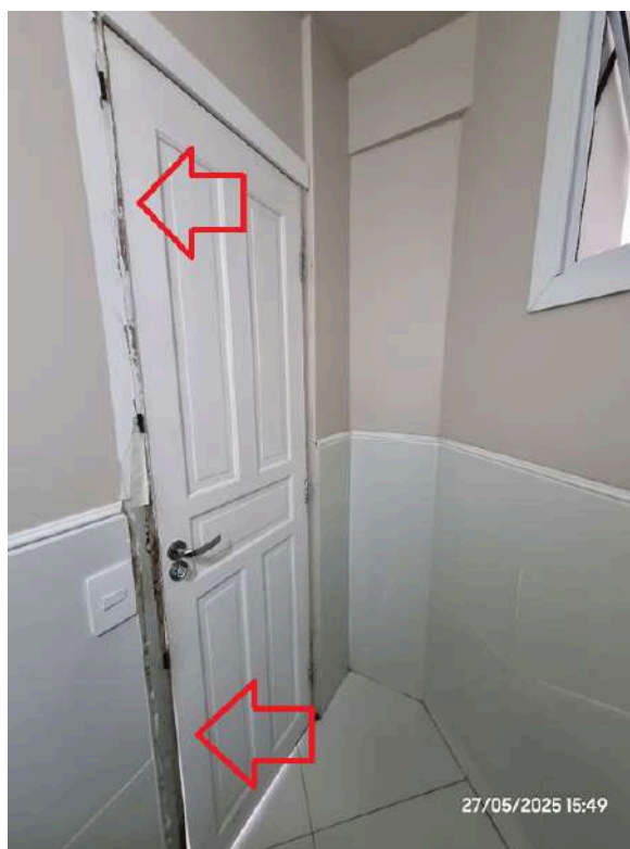
Imagem 015 - Ausência de guarnição na porta do WC social
