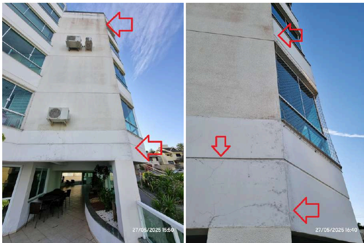
Imagens 077 e 078 - Fissura/trinca/rachadura e mofo na fachada lateral esquerda (parte frontal)
