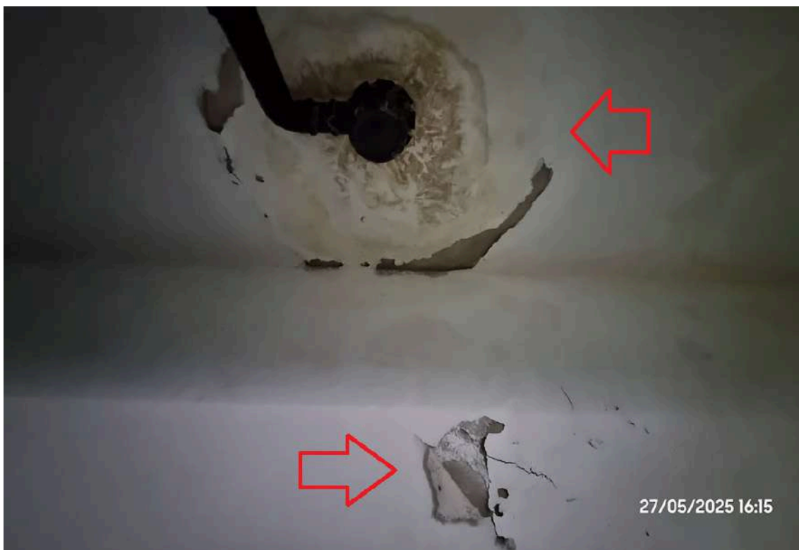
Imagem 045 - Empolamento/desplacamento e mofo no revestimento da laje da garagem subsolo
