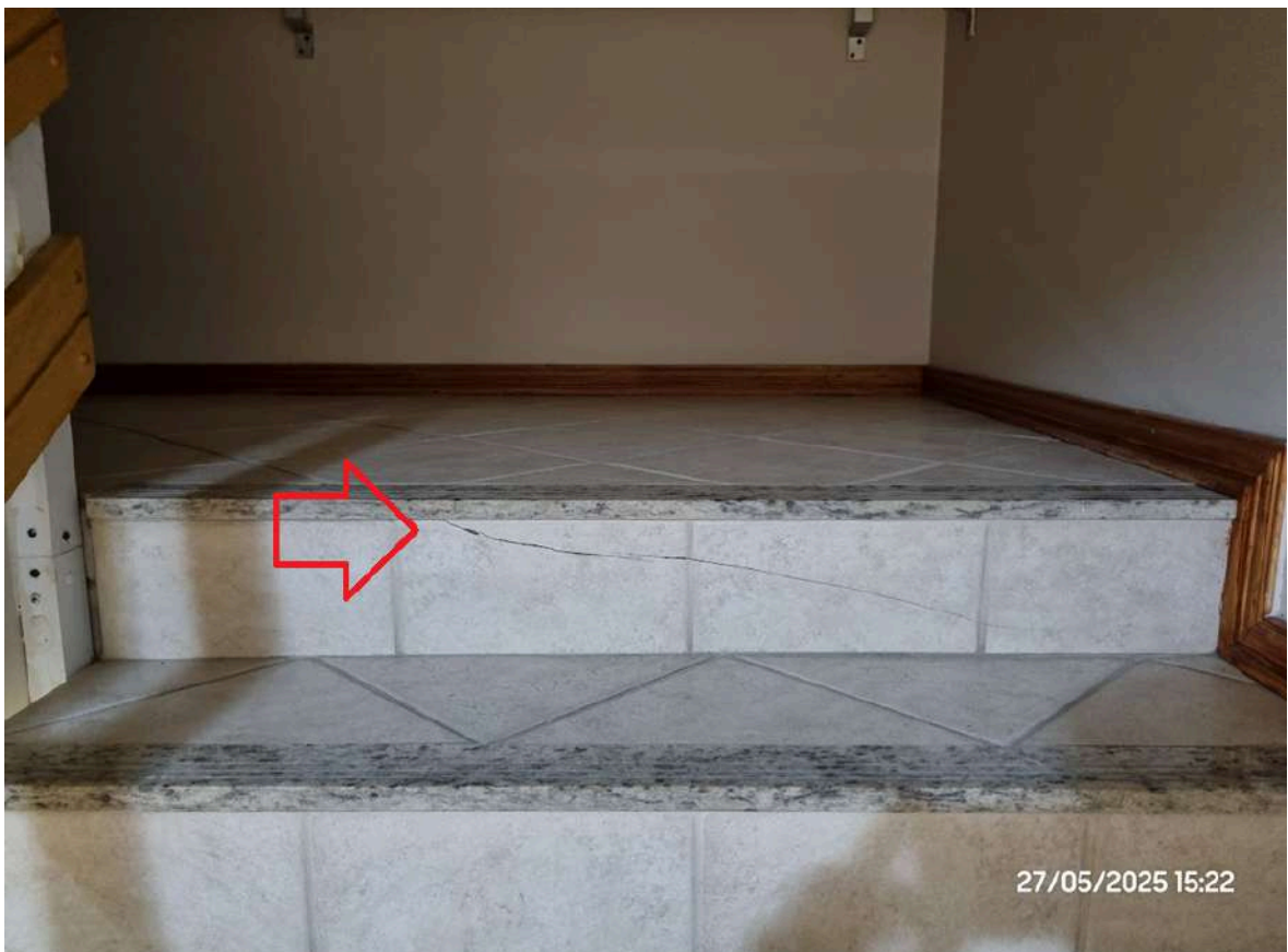
Imagem 011 - Revestimentos cerâmicos danificados na escada interna (3º pavimento tipo)
