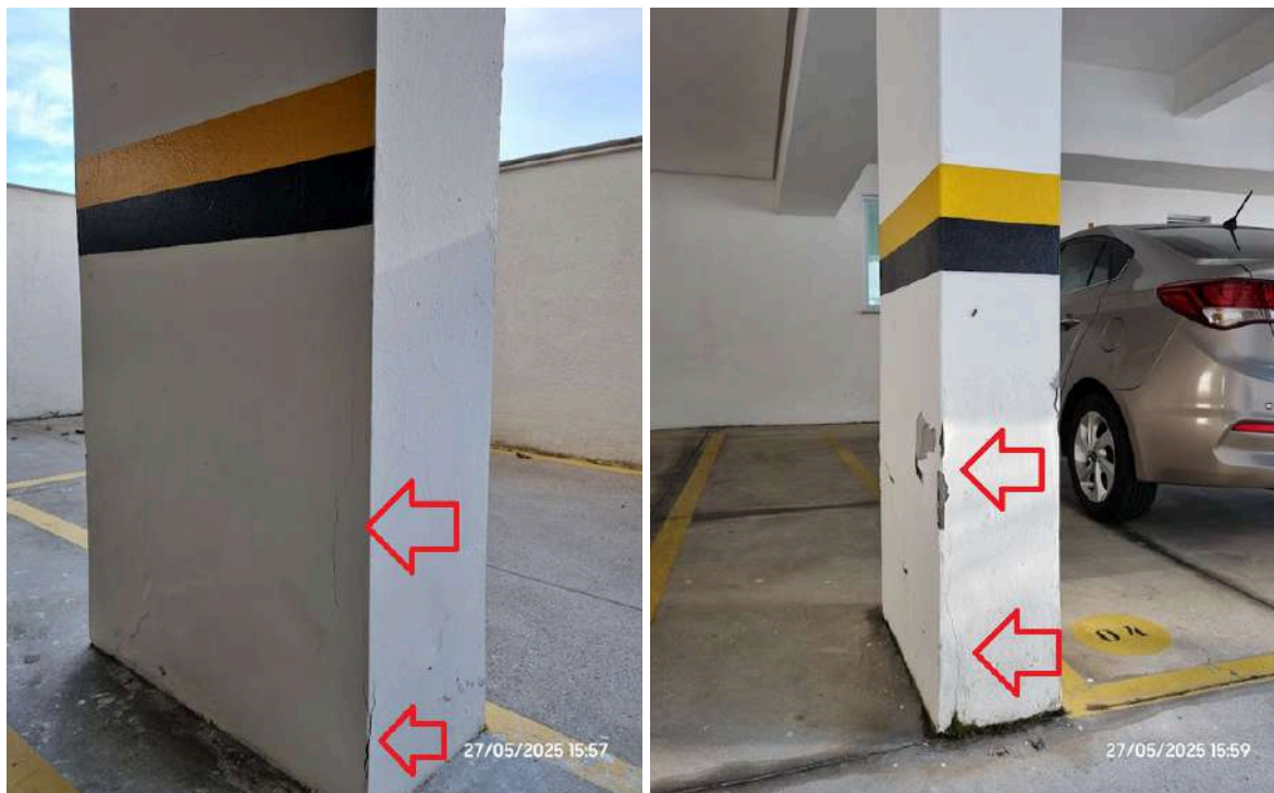
Imagens 061 e 062 - Fissura/trinca/rachadura e empolamento/deslocamento do revestimento de pilar da garagem térrea, próximo à vaga de estacionamento nº 02 (à esquerda) e próximo à vaga de estacionamento nº 04 (à direita)
