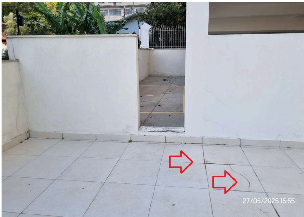
Imagem 014 - Revestimentos cerâmicos danificados na área de lazer descoberta
