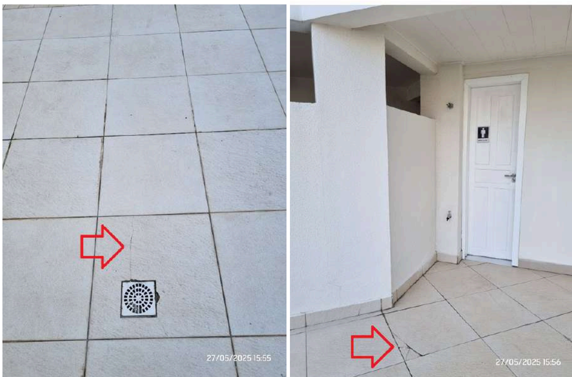
Imagens 012 e 013 - Revestimentos cerâmicos danificados na área de lazer descoberta
