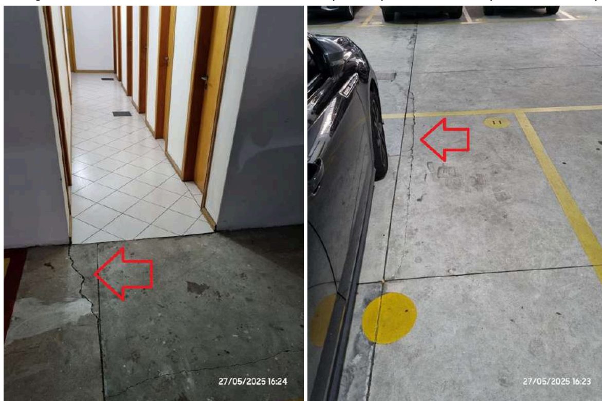
Imagens 106 e 107 - Fissuras/trincas/rachaduras no contrapiso do pavimento subsolo (garagem)
