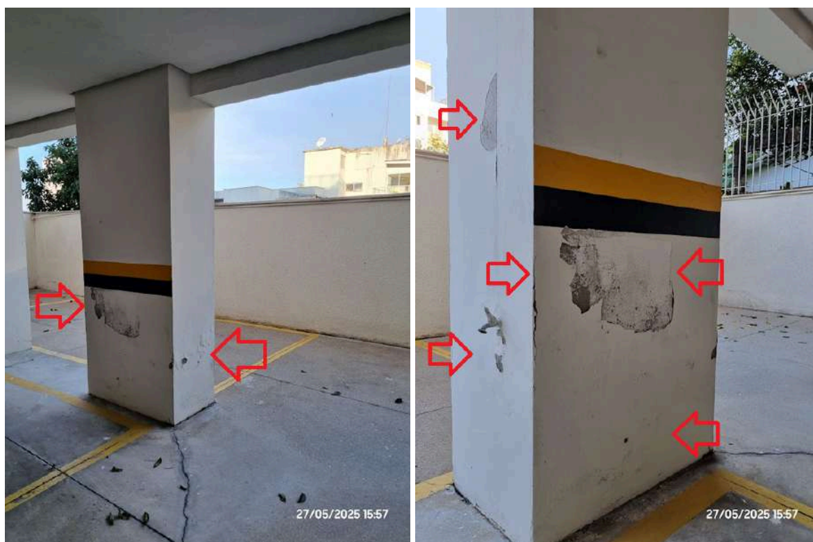
Imagens 059 e 060 - Empolamento/deslocamento da pintura de pilar da garagem térrea (próximo à vaga de estacionamento nº 02)
