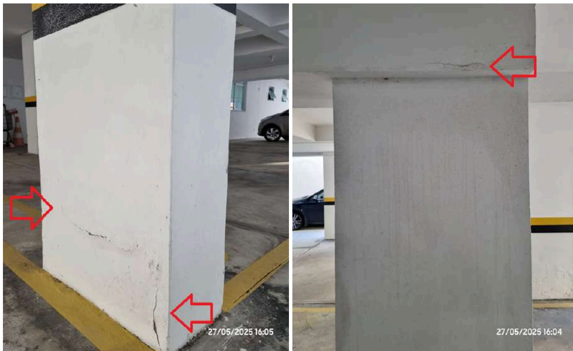
Imagens 069 e 070 - Fissura/trinca/rachadura e empolamento/deslocamento do revestimento de pilar da garagem térrea, próximo à vaga de estacionamento nº 07 (à esquerda) e fissura em viga na garagem térrea próximo à vaga de estacionamento nº 09 (à direita)
