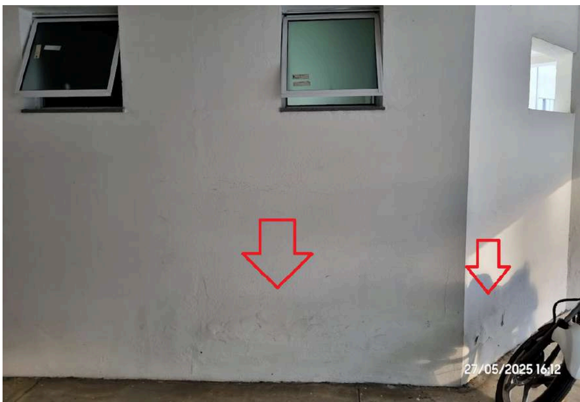
Imagem 020 - Empolamento/deslocamento do revestimento em parede da garagem térrea (próximo às vagas 02 e 03)
