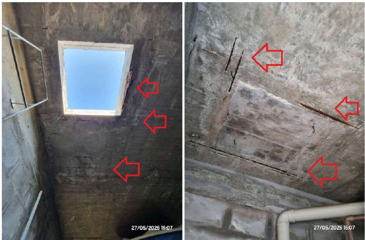
Imagens 007 e 008 - Corrosão de armadura na laje do reservatório superior
