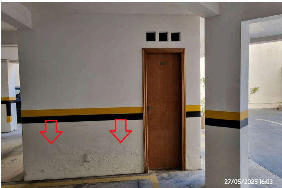
Imagem 024 - Empolamento/deslocamento do revestimento em parede da garagem térrea (entorno do hobby-box 08)
