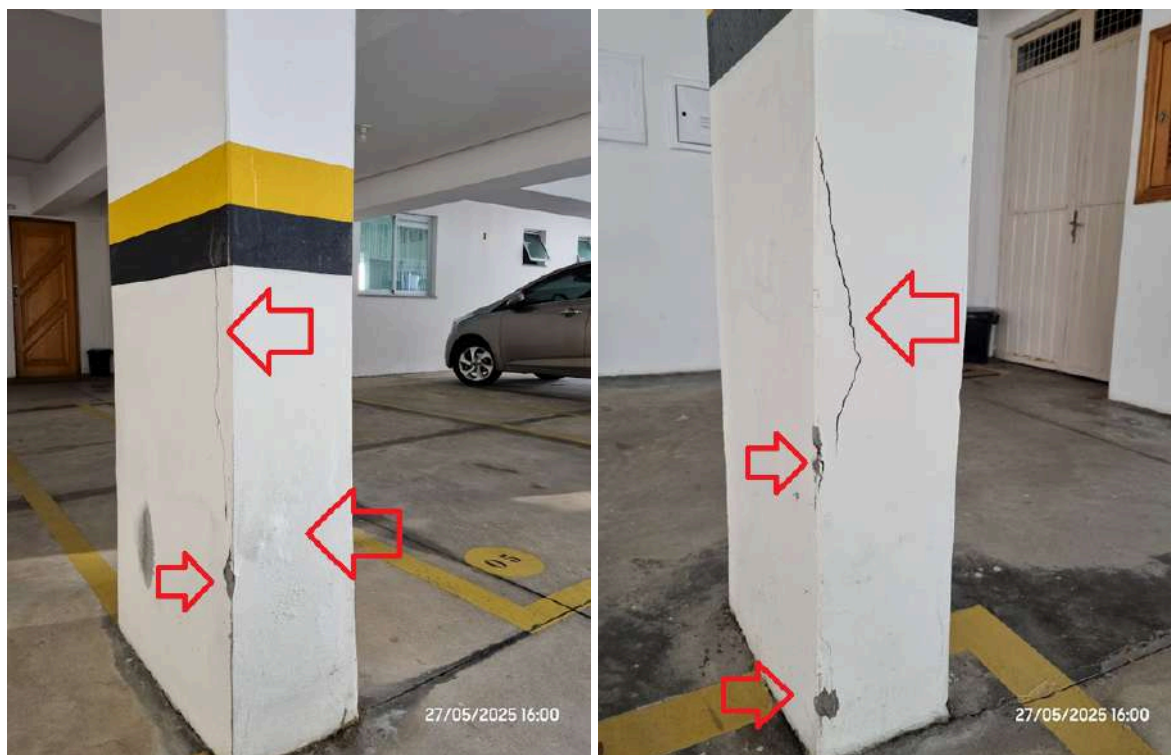
Imagens 065 e 066 - Fissura/trinca/rachadura e empolamento/deslocamento do revestimento de pilar da garagem térrea, próximo à vaga de estacionamento nº 06
