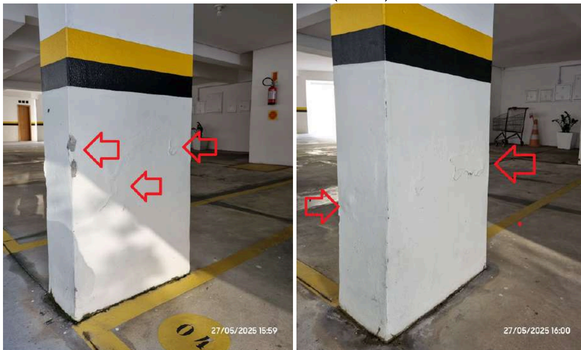
Imagens 063 e 064 - Fissura/trinca/rachadura e empolamento/deslocamento do revestimento de pilar da garagem térrea, próximo à vaga de estacionamento nº 04 (à esquerda) e próximo à vaga de estacionamento nº 05 (à direita)
