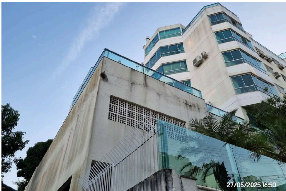
Imagem 102 - Fissura/trinca/rachadura, mofo e empolamento/deslocamento de revestimento na fachada frontal
