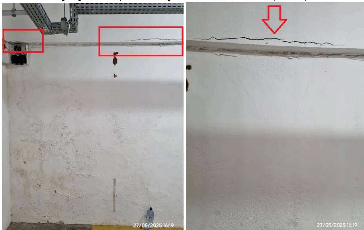
Imagens 071 e 072 - Fissura/trinca/rachadura em viga da garagem subsolo próximo à vaga de estacionamento nº 27
