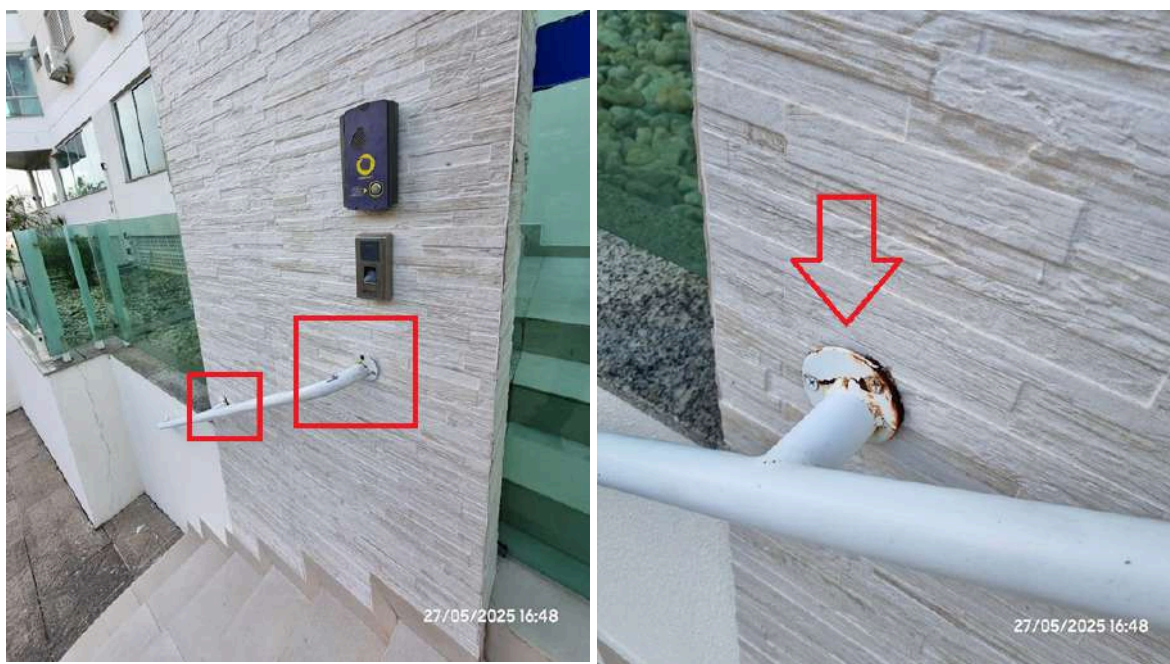
Imagens 108 e 109 - Corrosão no corrimão metálico da escada de acesso à edificação
