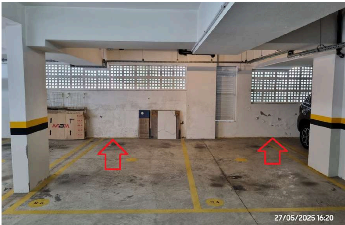
Imagem 029 - Empolamento e mofo no revestimento em parede da garagem subsolo (parede da fachada frontal)
