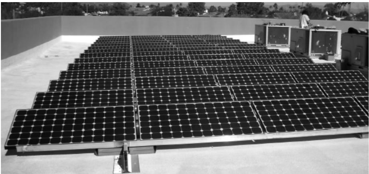
Figura 3 – Conjunto de módulos fotovoltaicos
