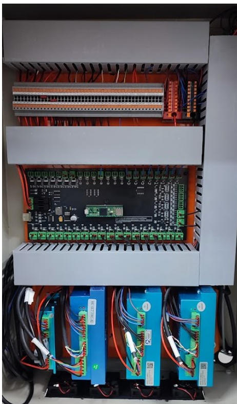
Figura 77 - Painel elétrico com a placa de controle principal e os drivers de controle dos motores.
