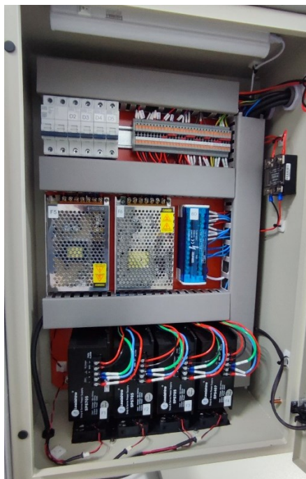
Figura 76 - Painelelétrico com as fontes de alimentação e dispositivos de segurança.
