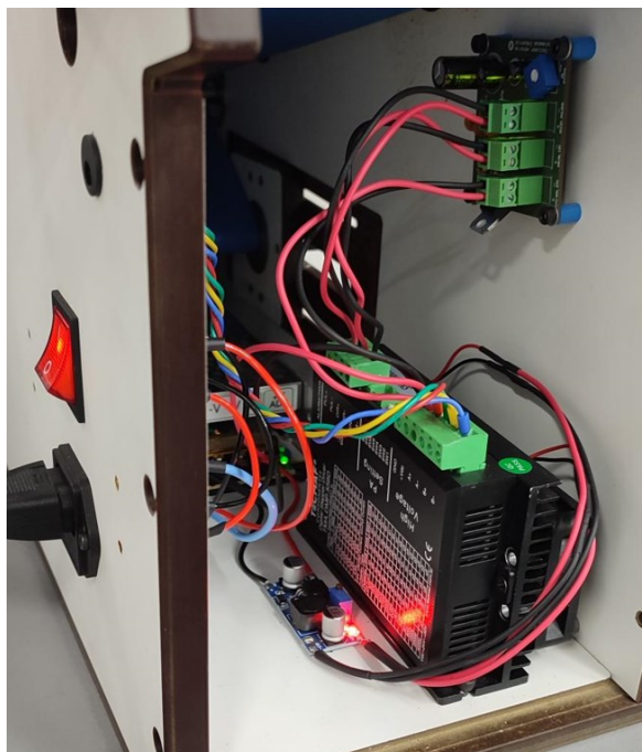
Figura 73 - Conexões elétricas esteira tracionada.
