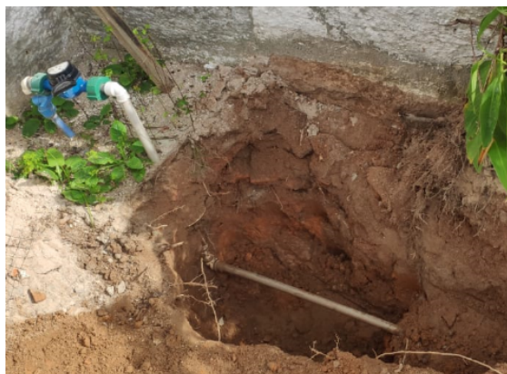
Figura 35 - Hidrômetro da casa
