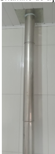
Figura 4 – Chaminé de aço inoxidável.
