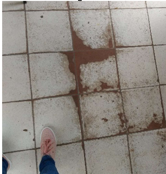
Figura 78 - Piso em revestimento cerâmico da guarita
