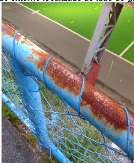
Figura 6 - Corrimão externo localizado ao lado do ginásio de esportes
