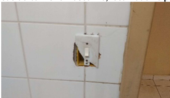
Figura 33 - Parede do banheiro masculino, localizado no pavimento térreo
