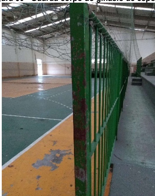
Figura 60 - Guarda corpo do ginásio de esportes
