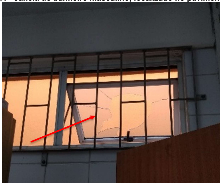
Figura 41 - Janela do banheiro masculino, localizado no pavimento térreo
