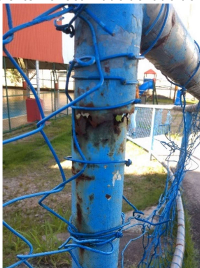
Figura 5 - Corrimão externo localizado ao lado do ginásio de esportes
