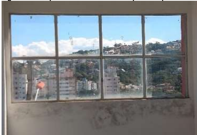
Figura 14 - Esquadria localizada na rampa entre pavimentos
