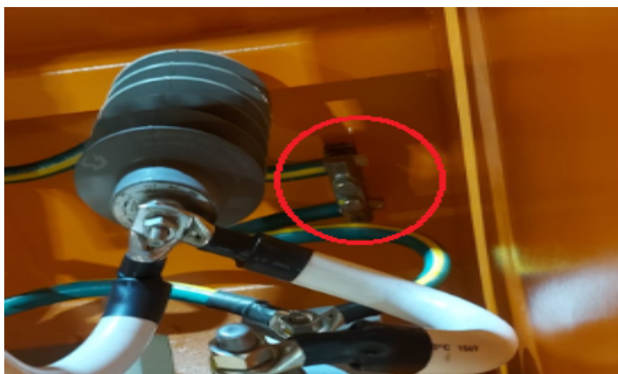
Figura 3- Cabo de aterramento estanhado e fixado na placa de aterramento.
