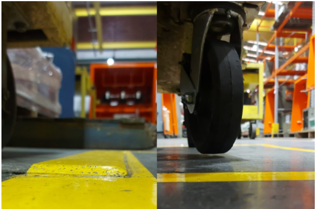
Figura 18- Desnívelamento do piso.
