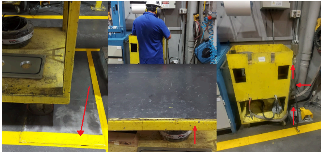
Figura 7- Desnível do piso (A), Bancada em frente ao prensa cabo (B), Maquinas em contato e cabos/mangueiras expostos (C).
