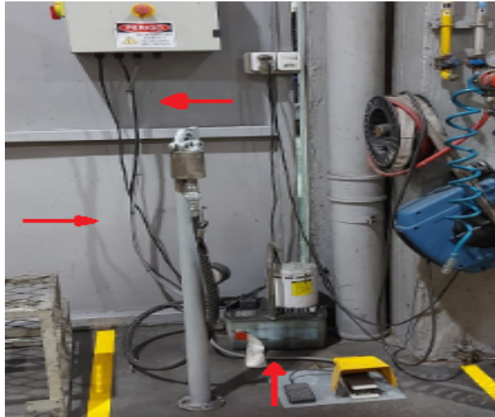
Figura 15 - Cabos de alimentação elétrica sem proteção.
