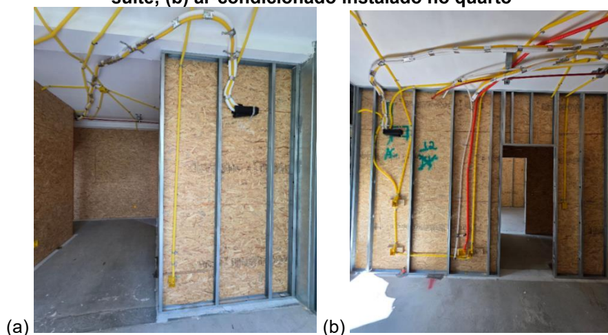
Figura 136 – Instalações do sistema de ar-condicionado: (a) ar-condicionado instalado na suíte; (b) ar-condicionado instalado no quarto
