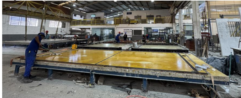
Figura 48 – Preparação das formas para recebimento da estrutura metálica do sistema de piso
