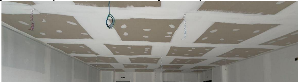
Figura 126 – Plaqueamento e tratamento das juntas das placas ST no forro do módulo
