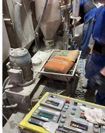
Figura 32 – Central do concreto (4a) - Fábrica Ivoti/ RS (VISIA)
