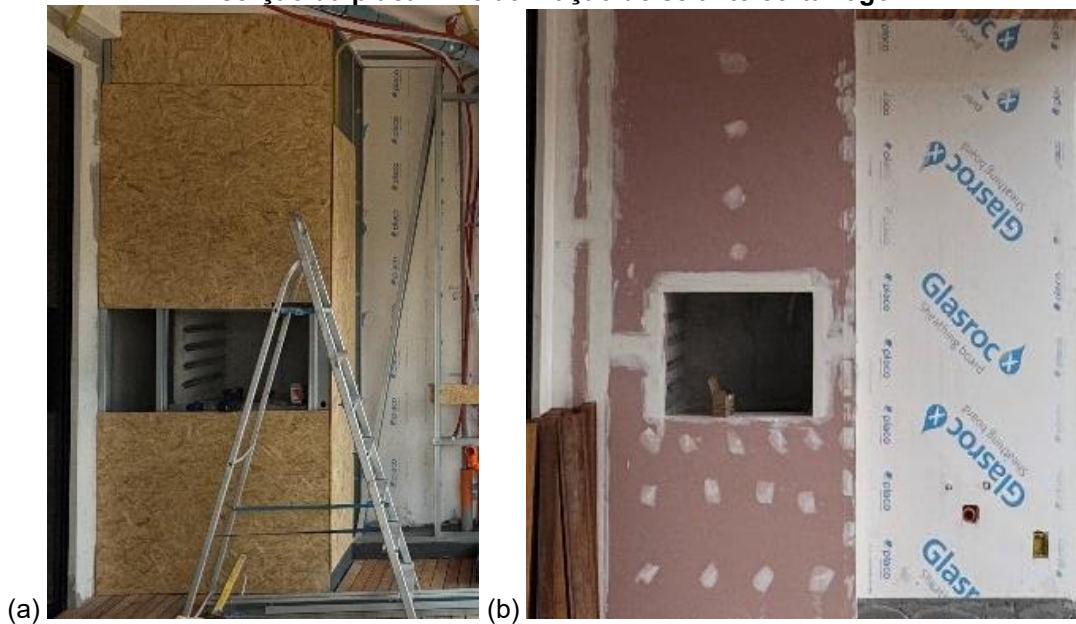
Figura 147 – Fechamento da churrasqueira com placas drywall : (a) inserção da placa OSB; (b) inserção da placa RF e utilização de selante corta-fogo
