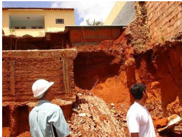
Figura 5 - Instabilidade de talude – Vizinhança da obra.
