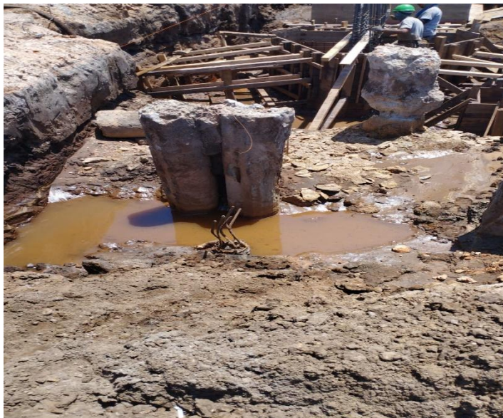
Figura 3 - Estaca fora de posição por erro de locação.
