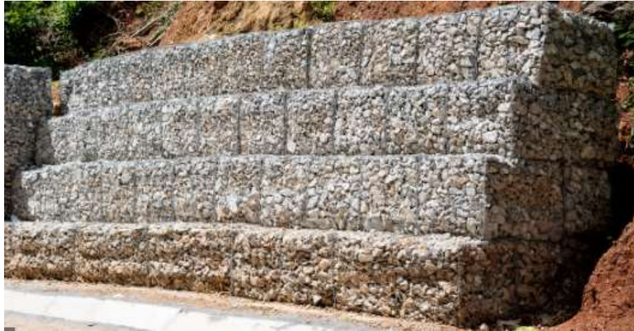
Figura 4: Barragem de Gabião.
