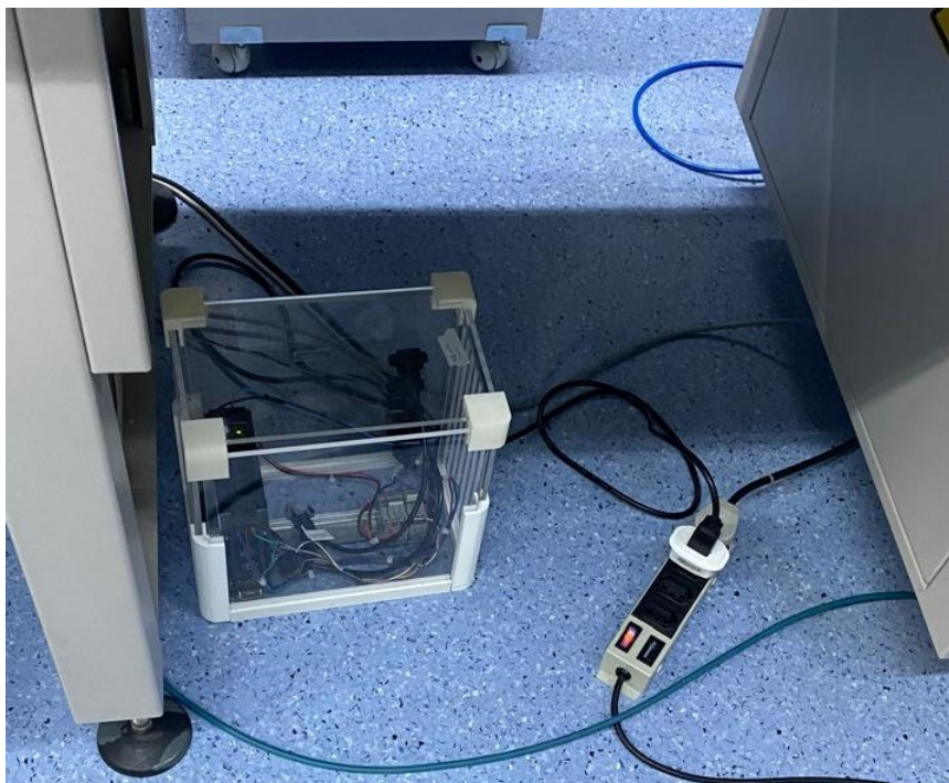
Figura 20 – Painel elétrico da câmera no chão
