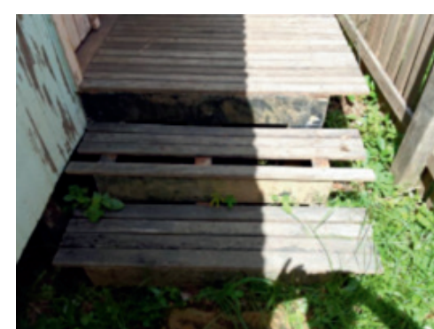
Deck de madeira danificado Fonte: Da autora (2020)
