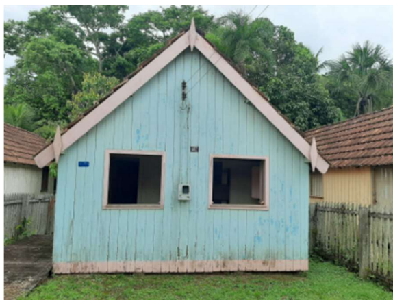
Figura 69 - Fachada frontal - umidade ascendente e sujeidade
