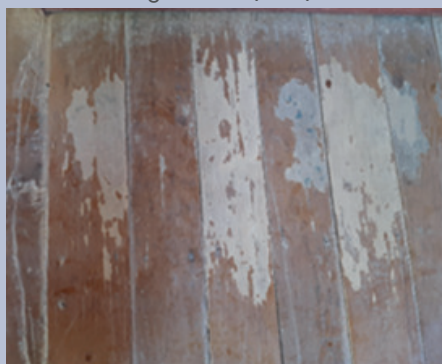
Desgaste do piso Fonte: Da autora (2020)
