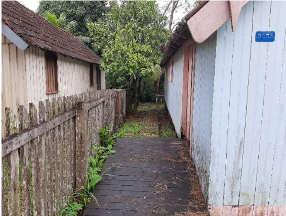
Figura 45 - Junção da rampa com a parede
