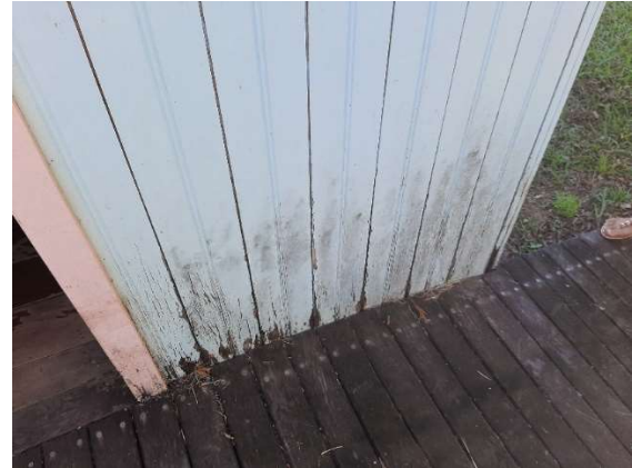
Figura 46 - Junção da rampa com a parede
