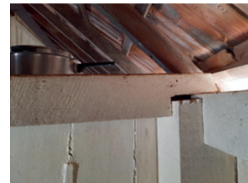
Folga da estrutura da cobertura Fonte: Da autora (2020)
