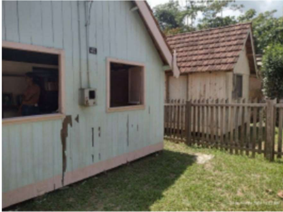
Figura 73 – Fachada frontal – descascamento da tinta
