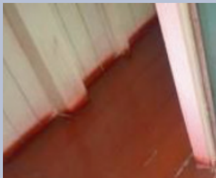
Marca de cera na parede Fonte: CSZ Engenharia (2015)
