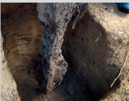
Apodrecimento dos barrotes Fonte: CSZ Engenharia (2015)
