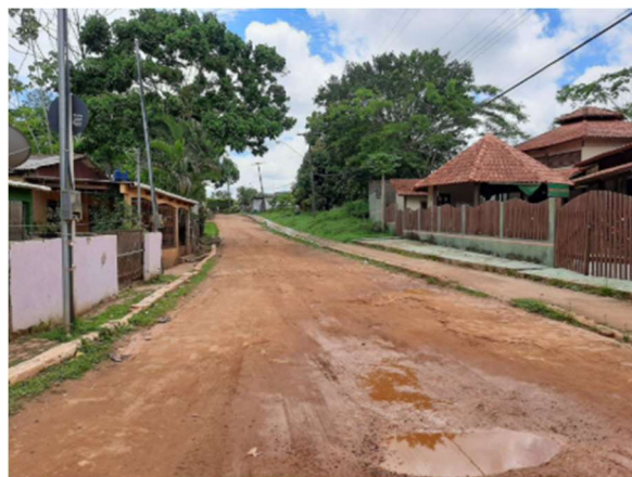
Figura 107 - Rua Batista de Morais - área de empocamento
