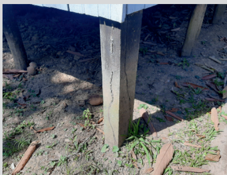
Presença de cupim no barroto Fonte: CSZ Engenharia (2015)
