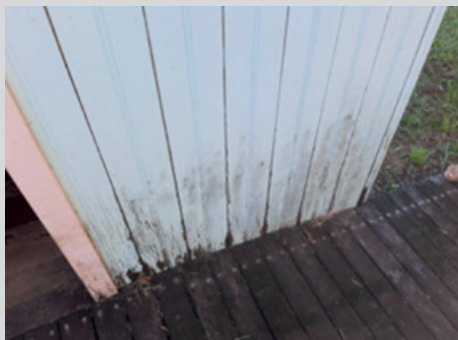
Umidade ascendente Fonte: Da autora (2022)
