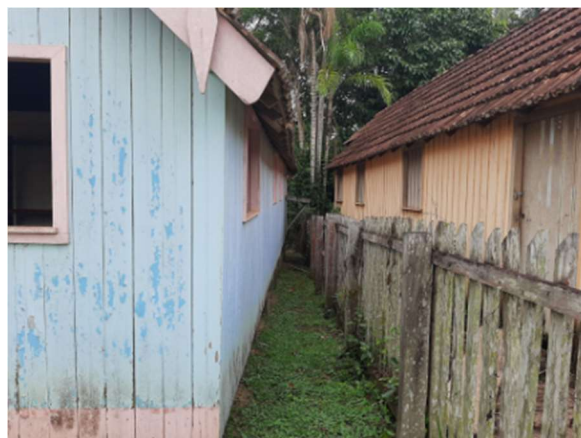
Figura 70 - Descascamento da pintura na fachada frontal
