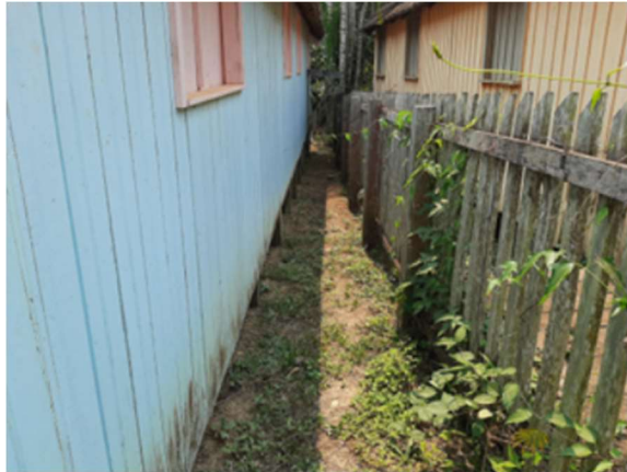
Figura 91 - Vegetação do imóvel vizinho invadindo o terreno da Casa de Chico Mendes
