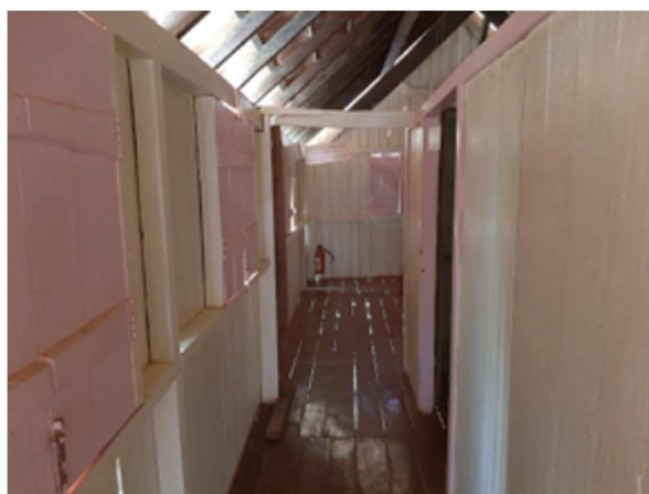
Figura 79 - Frestas no piso
