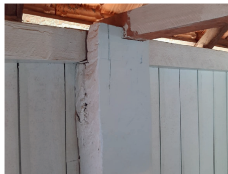
Rachadura estabilizada Fonte: Da autora (2023)
