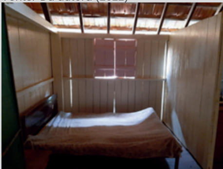
Frestas na parede Fonte: Da autora (2022)
