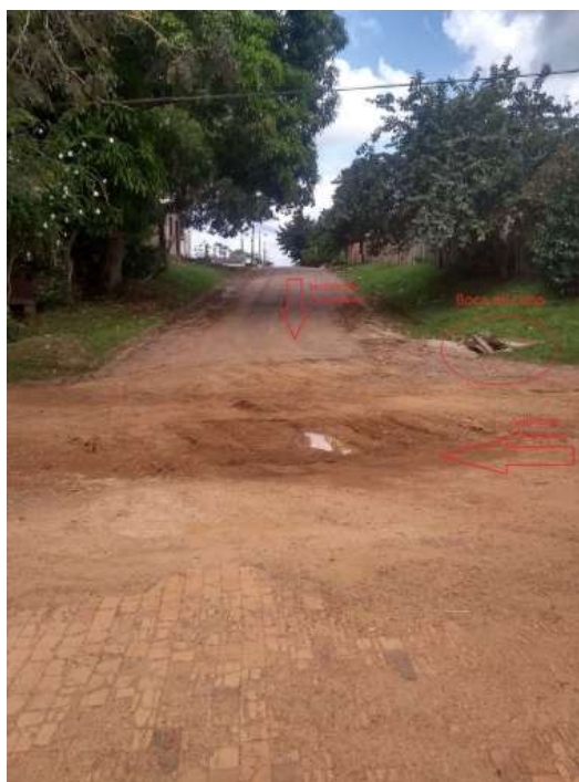
Figura 108 - Rua Pio Nazário - área de empocamento e boca de lobo
