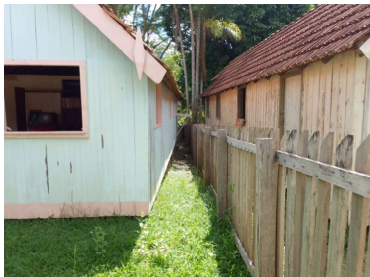
Figura 26 - Marca da enchente de 2024 na fachada e ponteira
