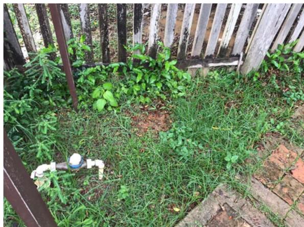
Figura 85 - Hidrômetro e ponto de torneira de jardim quebrado
