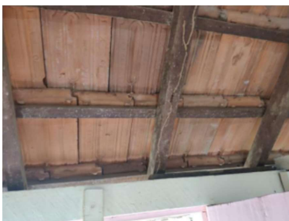
Figura 68 - Presença de cupim
