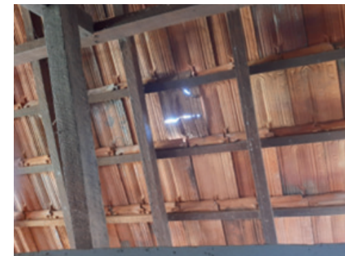
Telha quebrada Fonte: Da autora (2020)
