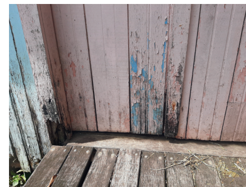
Umidade ascendente na porta Fonte: Da autora (2020)
