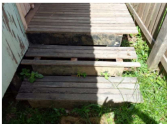
Figura 95 - Deck de madeira com ripas danificadas
