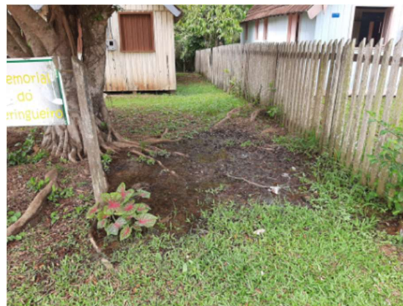
Figura 86 - Vazamento de água
