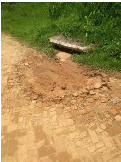
Figura 109 - Rua Batista de Moraes - boca de lobo (2020)
