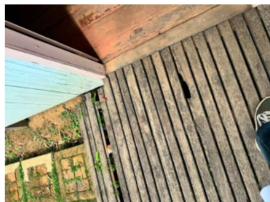
Figura 96 - Deck de madeira com ripas danificadas
