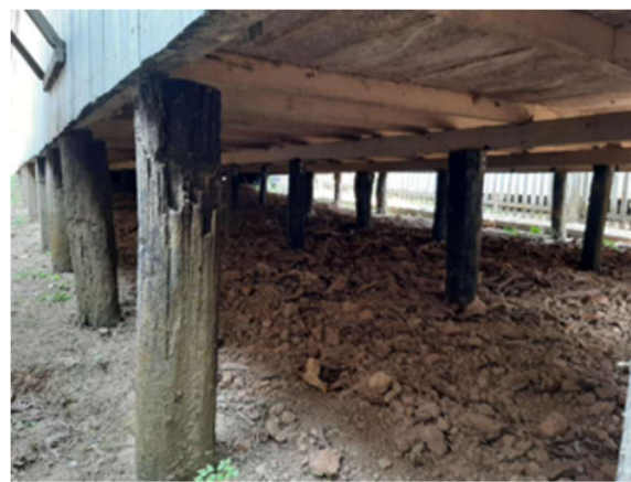
Figura 64 - Deterioração dos barrotes
