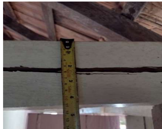
Figura 48 - Rachadura na linha tesoura
