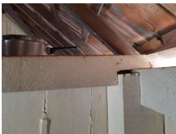
Figura 67 - Falhas de execução
