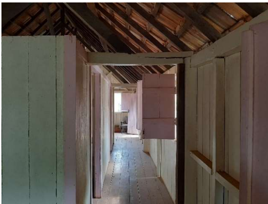
Figura 47 – Rachadura na linha tesoura
