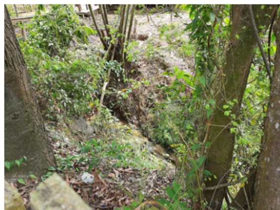
Figura 90 - Erosão nos fundos do imóvel
