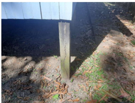
Figura 63 - Presença de cupim nos barrotes
