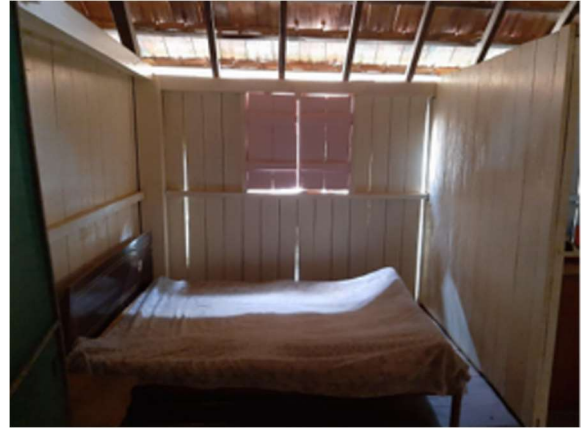
Figura 74 – Frestas nas paredes
