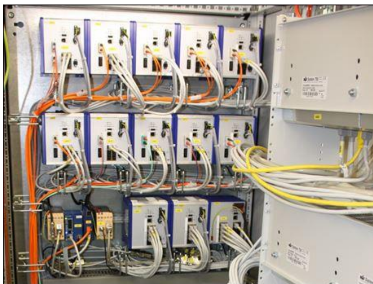
Figura 10: Switches em painel de Subestação com IEC61850
