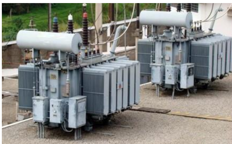
Figura 4: Transformador de potência
