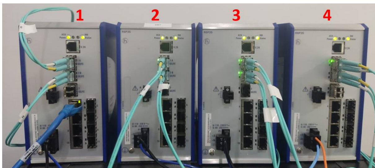
Figura 24: Foto da rede de switches Hirschmann
