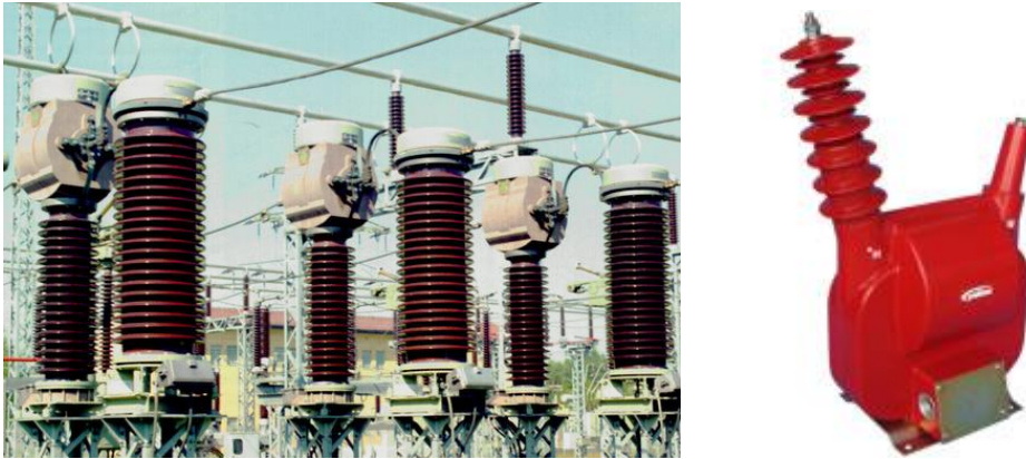
Figura 6: Transformador de potencial
