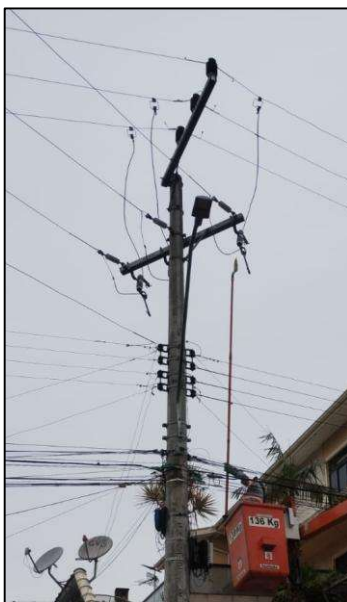
Figura 41 – Teste de detecção de tensão da concessionária de energia
