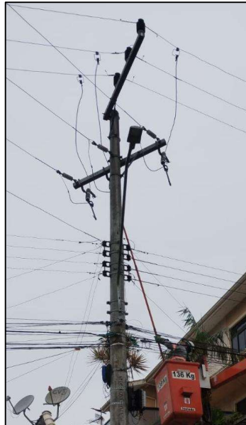
Figura 40 – Abertura das chaves fusíveis no poste pela concessionária de energia
