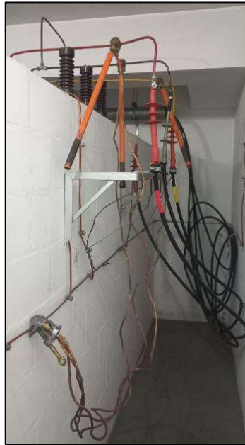
Figura 43 – Aterramento temporário na entrada de energia
