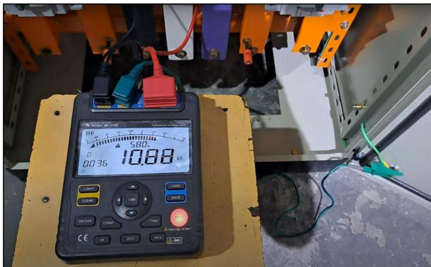
Figura 72 – Ensaio de resistência de isolamento entre os barramentos de força com o instrumento megômetro
