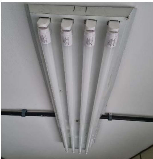
Figura 6: Foto de luminária instalada
