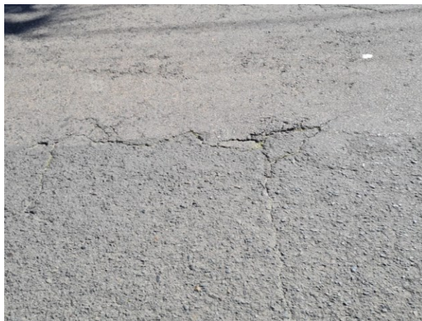
Figura 10: Trinca isolada transversal curtas.
