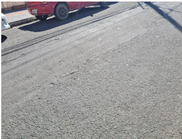
Figura 8: Trincas isoladas longitudinais longas, remendo e desgaste.
