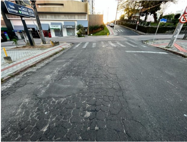
Figura 16: Trincas interligadas tipo “couro de jacaré” com erosão nas bordas.
