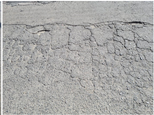
Figura 9: Trincas interligadas tipo “couro de jacaré” com erosão nas bordas.
