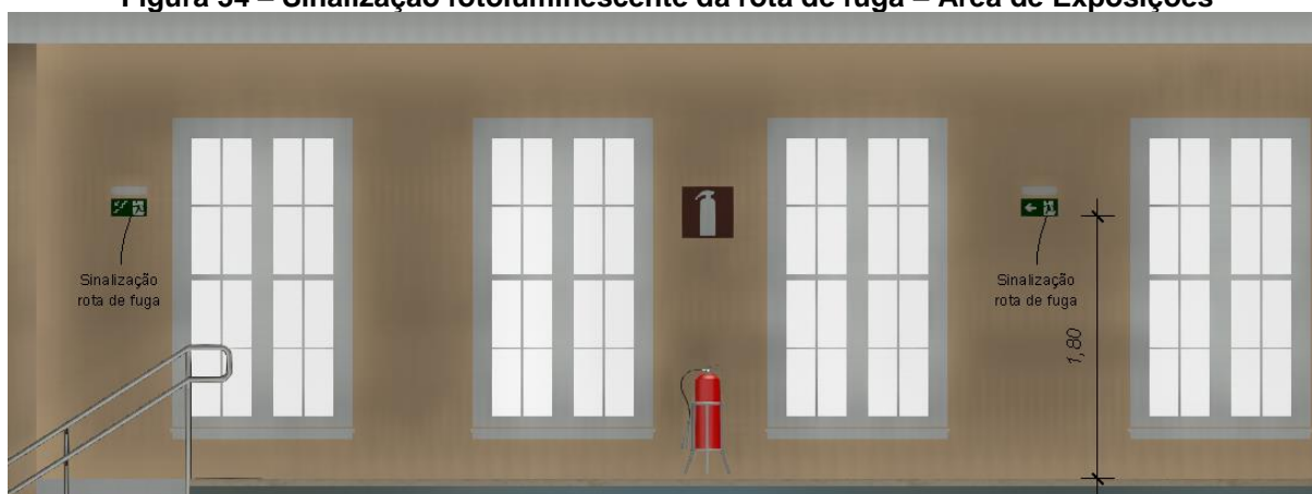
Figura 34 – Sinalização fotoluminescente da rota de fuga – Área de Exposições
