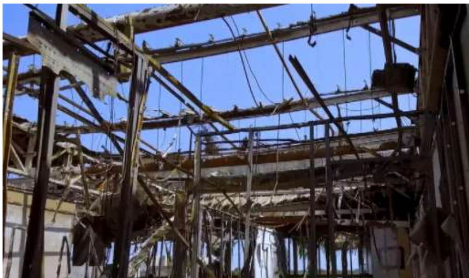
Figura 5 – Sala da presidência após sinistro
