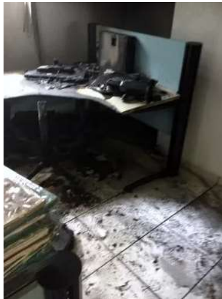
Figura 3 - Sala da vara do trabalho incendiada
