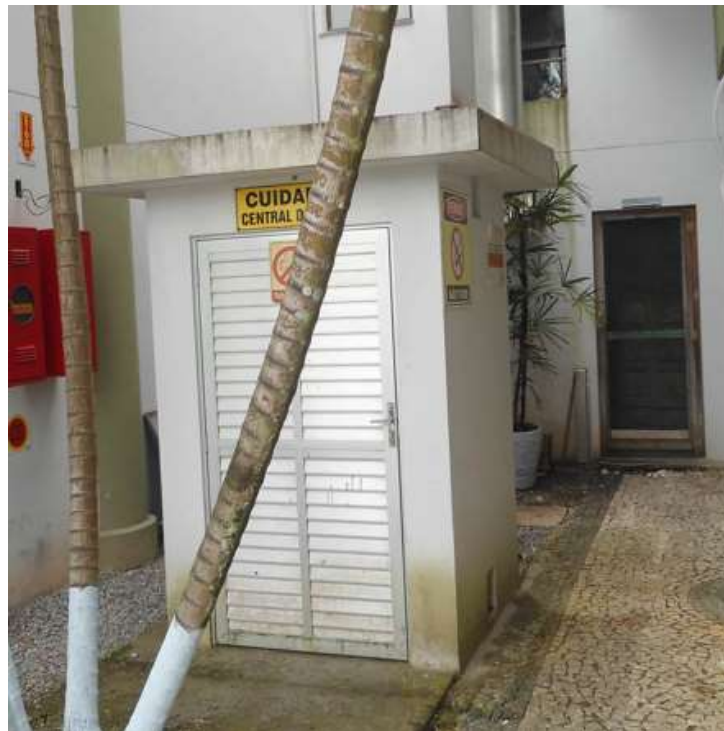
Figura 32 – Central de gás combustível
