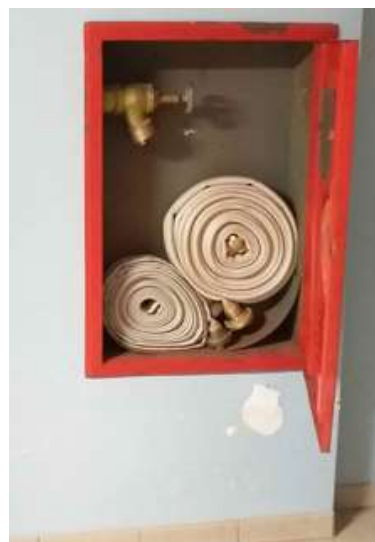
Figura 39 – Abrigo de mangueiras
