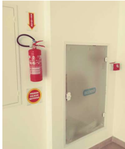
Figura 24 – Exemplo de instalação de extintor no fórum
