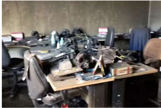
Figura 2 - Equipamentos do TJ do Tocantins destruídos pelo incêndio
