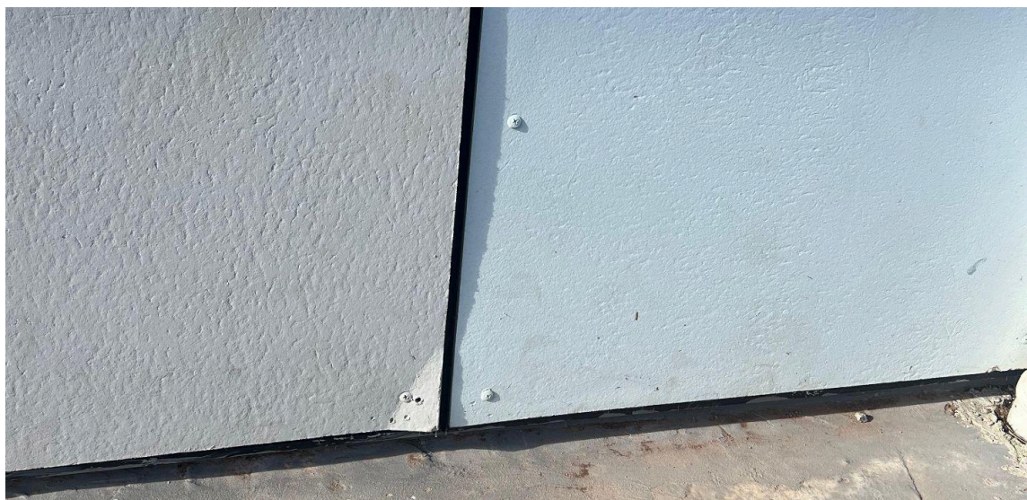
Foto 10 - Deformação na Extremidade de Placa Cimentícia.
