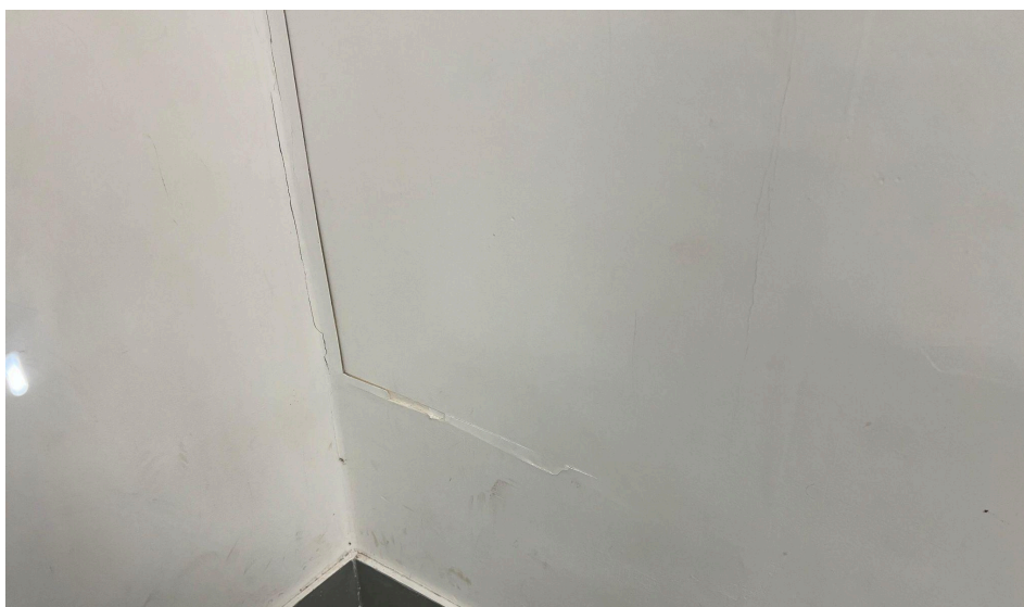
Foto 17 - Fissura em Encontro de Paredes (2).
