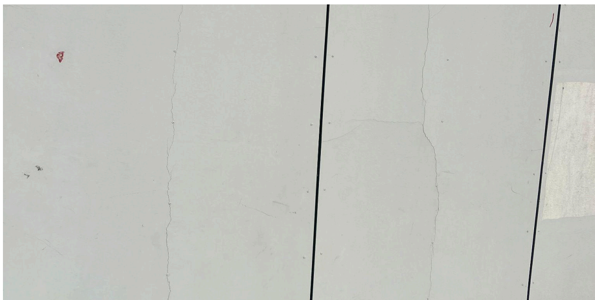
Foto 14 - Trinca Vertical de Placa Cimentícia (2).
