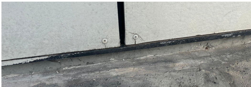
Foto 11 - Rachaduras ao Redor dos Pontos de Fixação (1).
