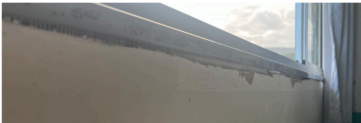
Foto 23 - Dano em Placa de Gesso Acartonado Abaixo da Janela (5).
