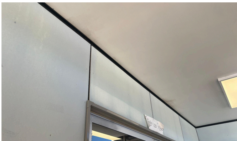
Foto 27 - Descoloração na Pintura de Chapas Cimentícias (1).
