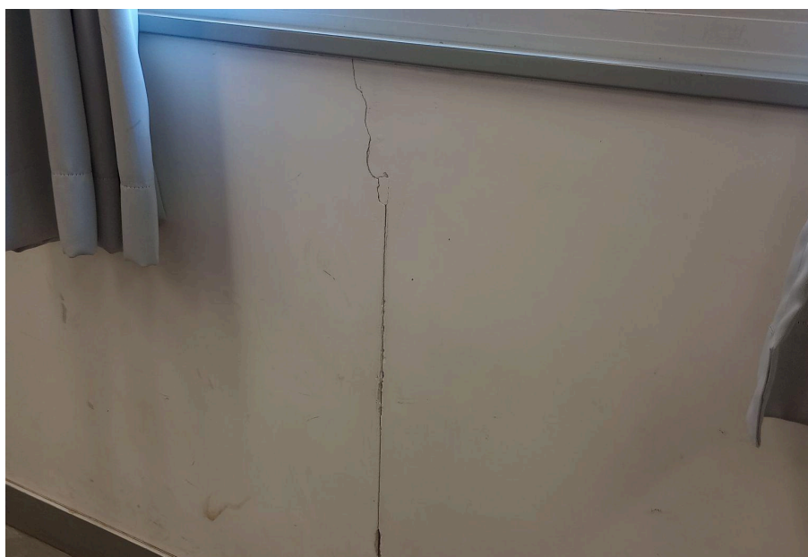
Foto 26 - Trinca Vertical em Placa de Gesso Acartonado (2).
