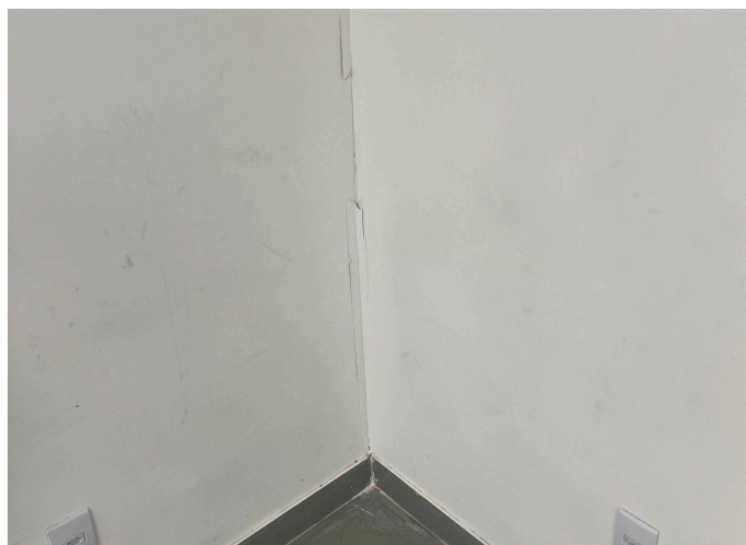
Foto 16 - Fissura em Encontro de Paredes (1).
