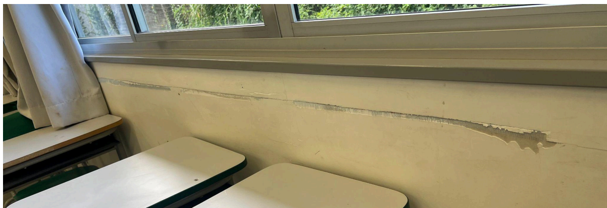
Foto 21 - Dano em Placa de Gesso Acartonado Abaixo da Janela (3).
