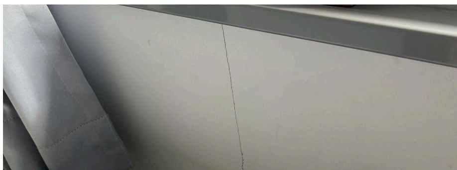
Foto 25 - Trinca Vertical em Placa de Gesso Acartonado (1).
