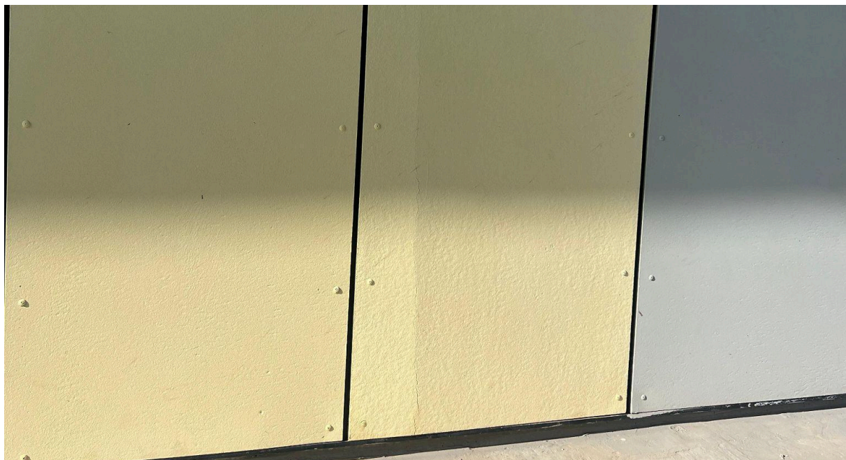
Foto 13 - Trinca Vertical de Placa Cimentícia (1).
