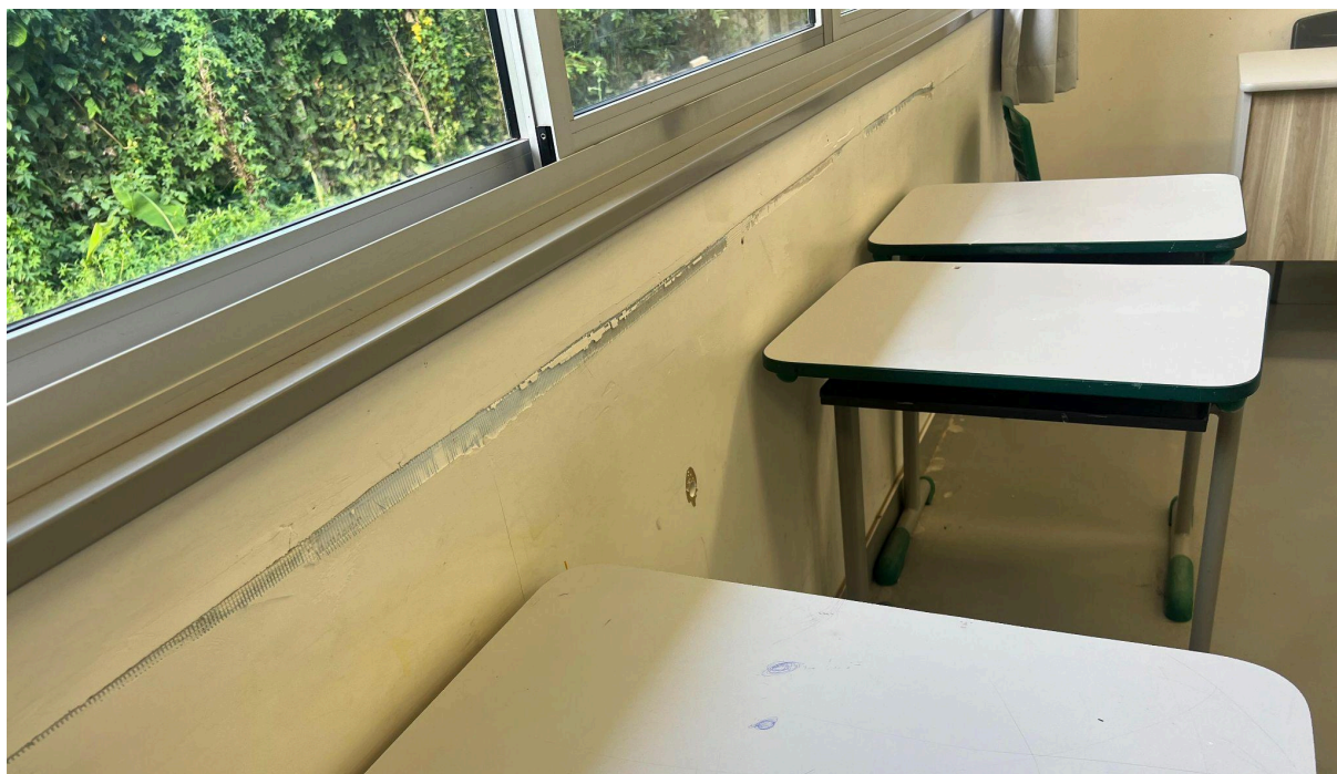
Foto 22 - Dano em Placa de Gesso Acartonado Abaixo da Janela (4).
