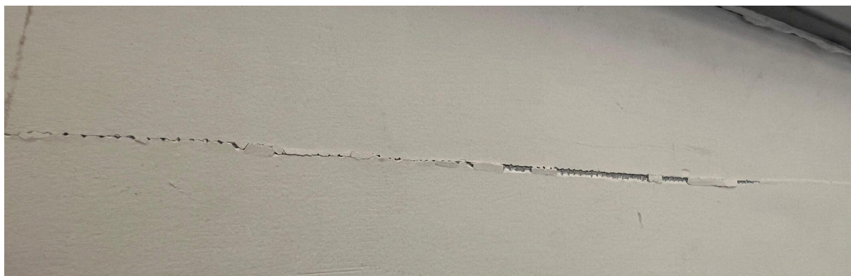
Foto 20 - Dano em Placa de Gesso Acartonado Abaixo da Janela (2).
