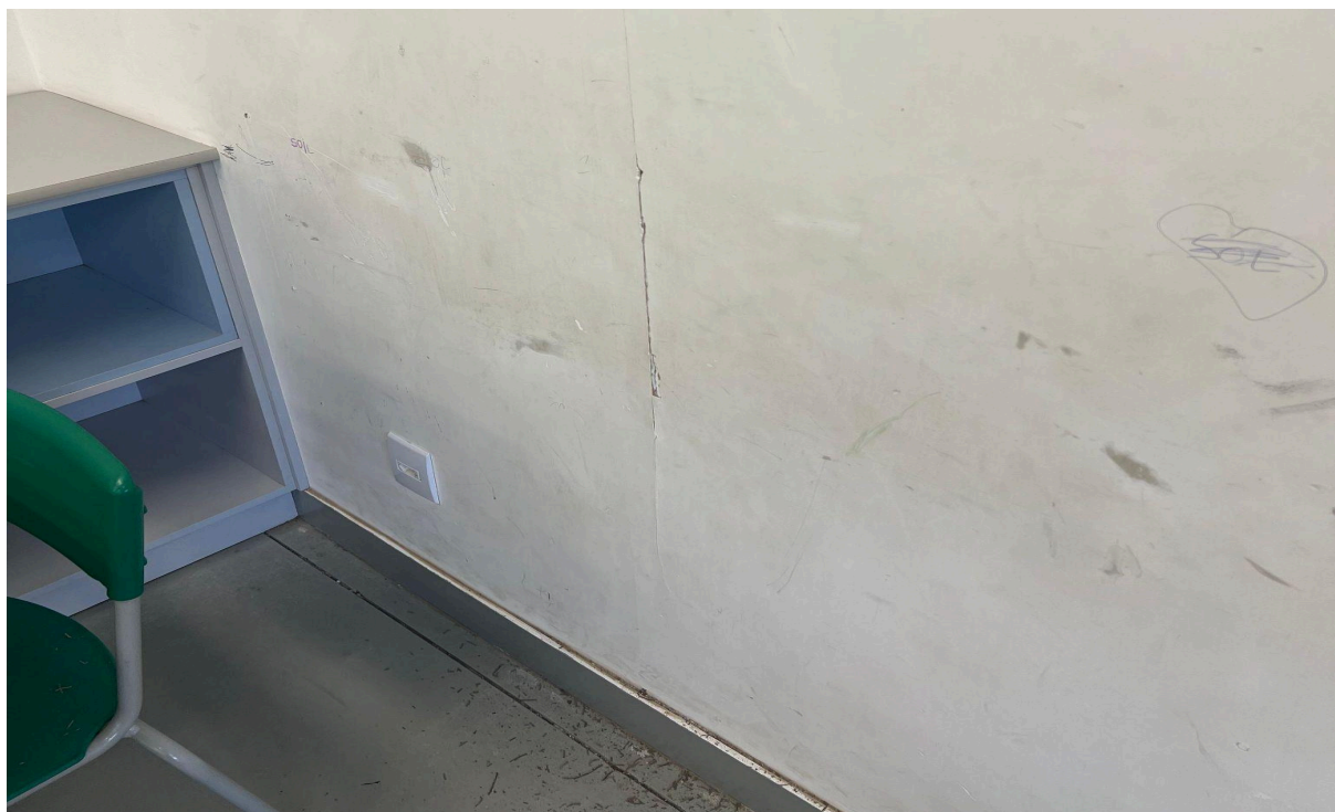
Foto 24 - Dano em Placa de Gesso Acartonado.
