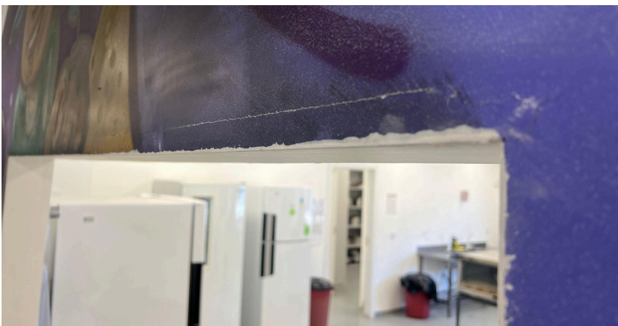
Foto 8 - Fissura na Abertura do Painel.
