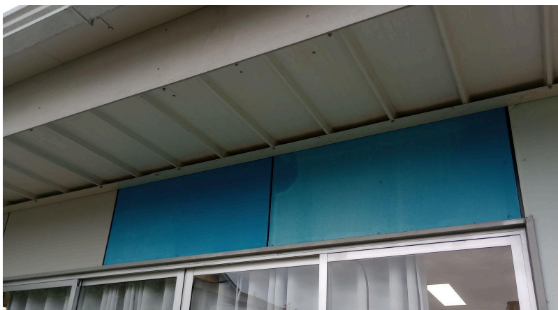
Foto 28 - Descoloração na Pintura de Chapas Cimentícias (2).
