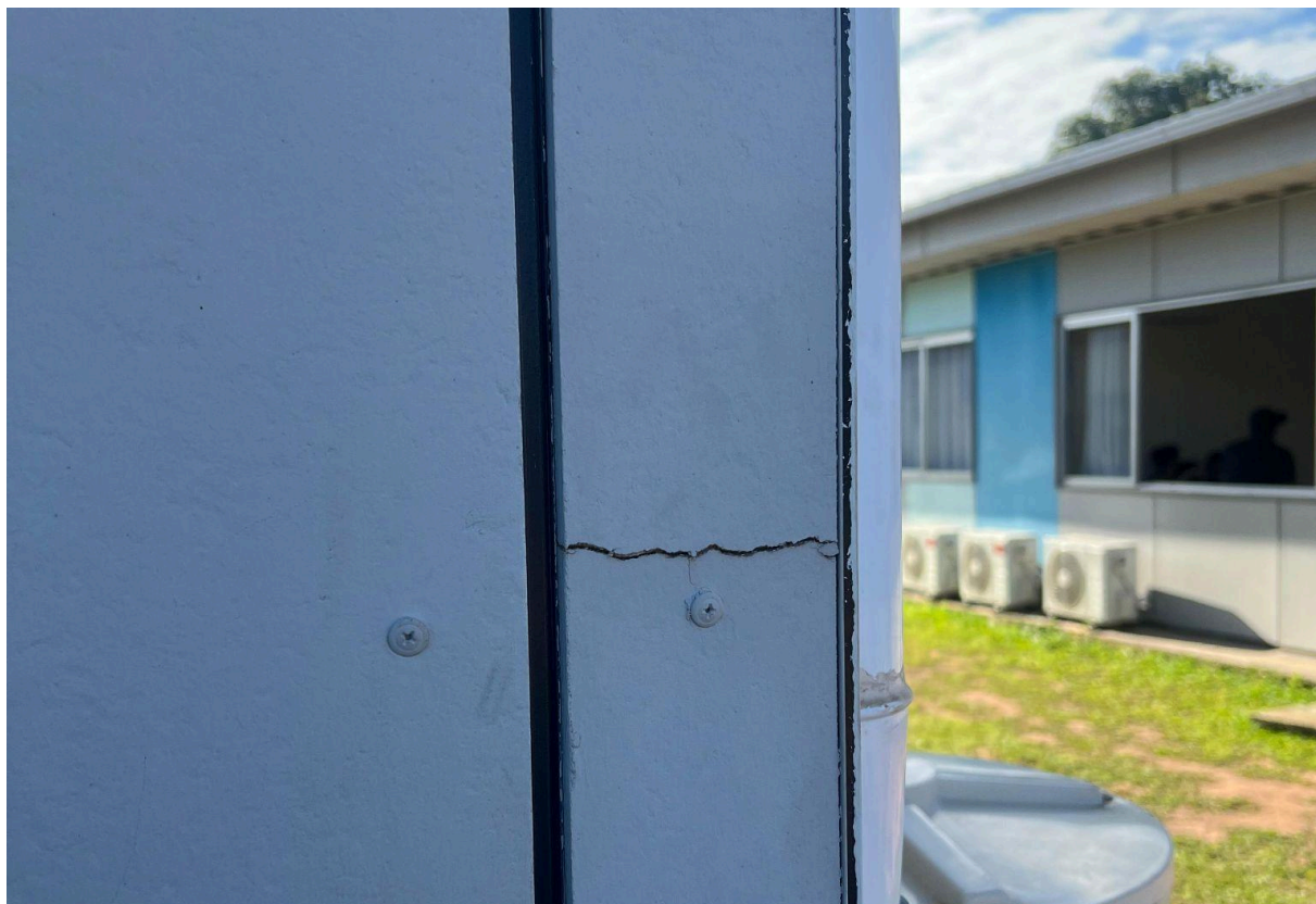
Foto 15 - Trinca Horizontal de Placa Cimentícia.
