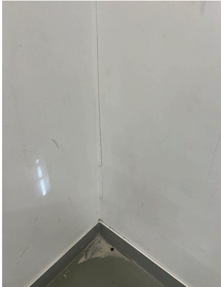
Foto 18 - Fissura em Encontro de Paredes (3).
