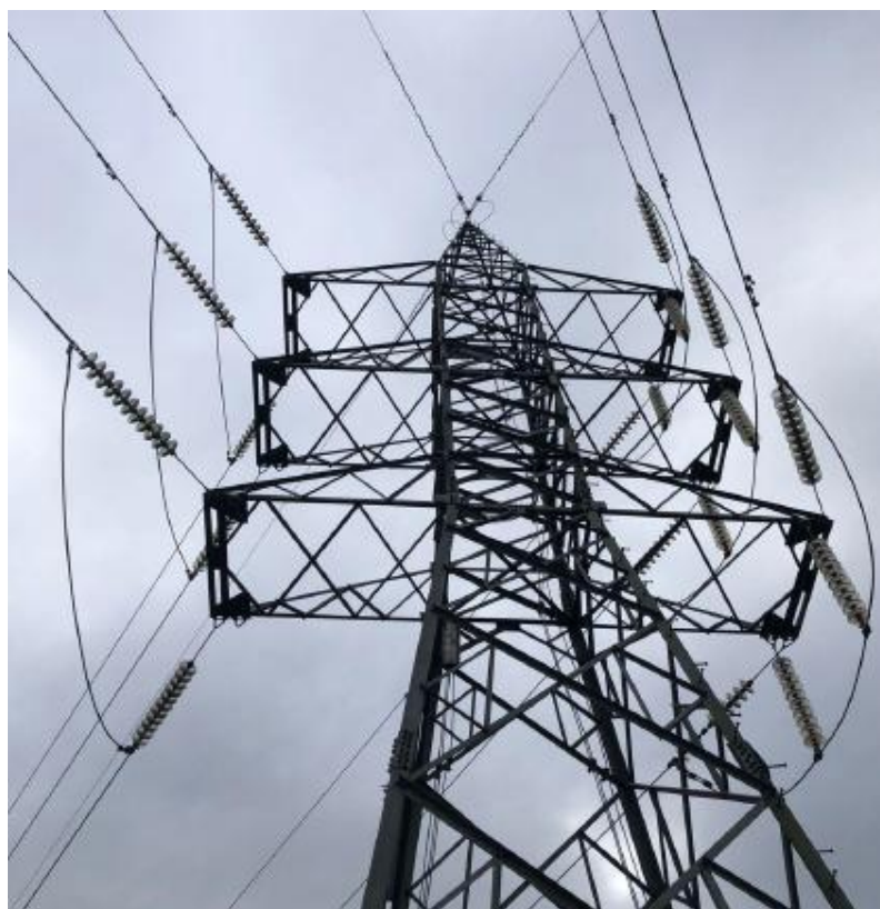
Figura 4 - Torre de ancoragem LT 138 kV
