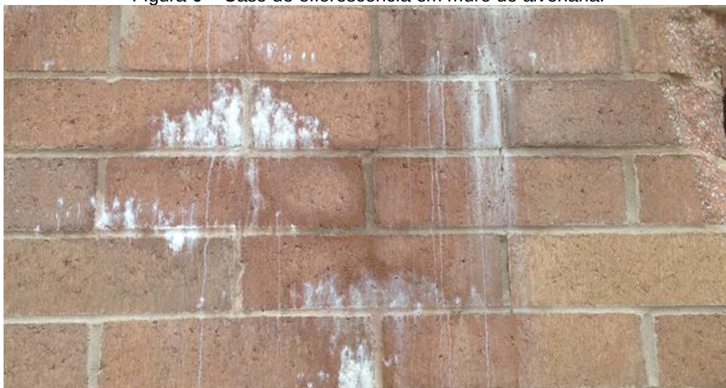
Figura 6 – Caso de eflorescência em muro de alvenaria.
