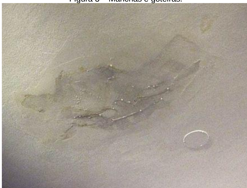
Figura 3 – Manchas e goteiras.
