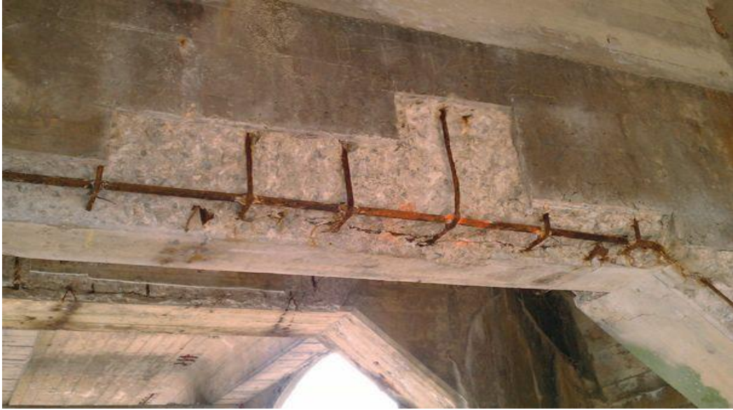
Figura 5 – vigas enferrujadas causam deslocamento de concreto.
