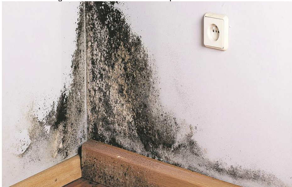
Figura 4 – Mancha de mofo em parede de alvenaria.
