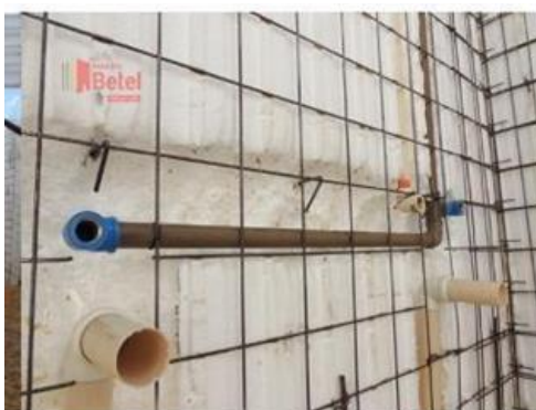
Figura 6 - Instalações hidráulicas embutidas no painel
