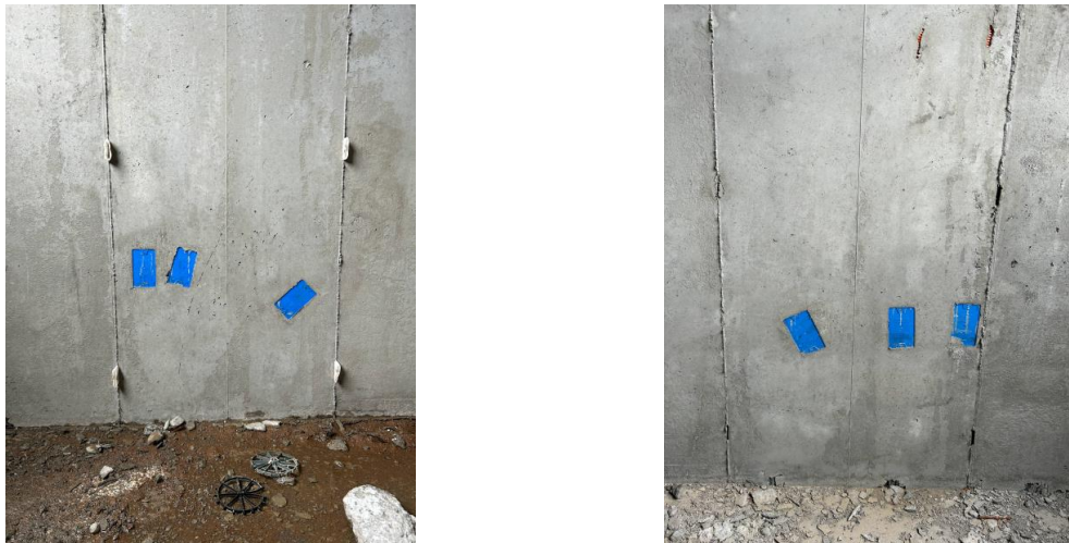
Figura 43 - Caixas de elétrica desalinhas
