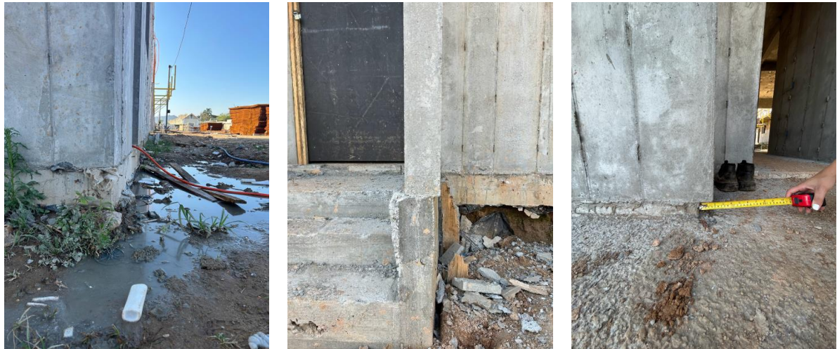
Figura 31 - Desalinhamento da fundação com a fôrma
