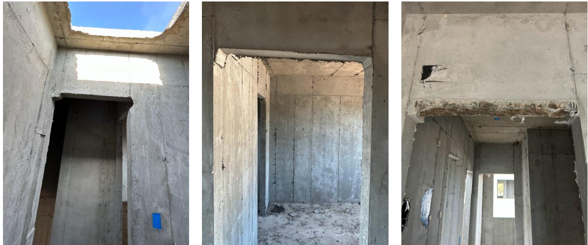
Figura 42 - Defeito nos vãos das abertura das portas
