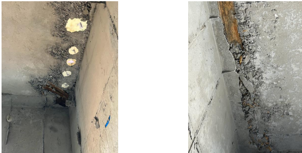
Figura 36 - Segregação do concreto na superfície da laje
