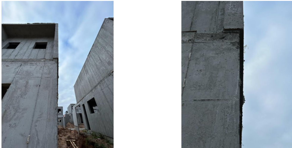
Figura 33 - Desaprumo entre os pavimentos
