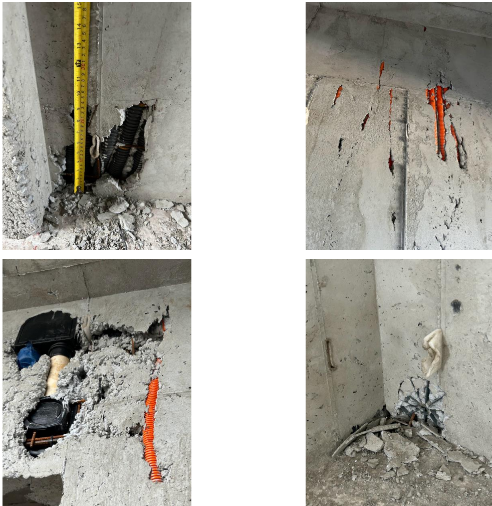
Figura 41 - Falhas de cobertura do concreto
