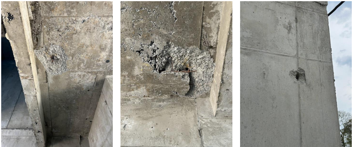
Figura 40 - Danos causados pela retirada de pinos e faquetas de travamento
