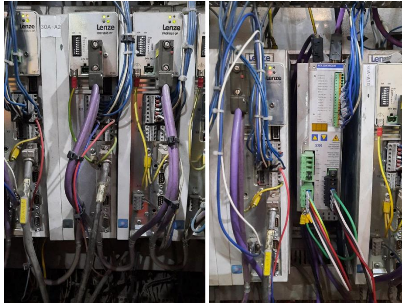
Figura 26. Instalação Servodrive Kollmorgen S300
