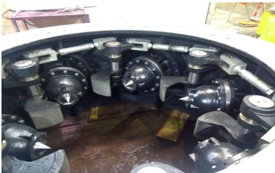
Figura 8: Turbina Pelton (interior)
