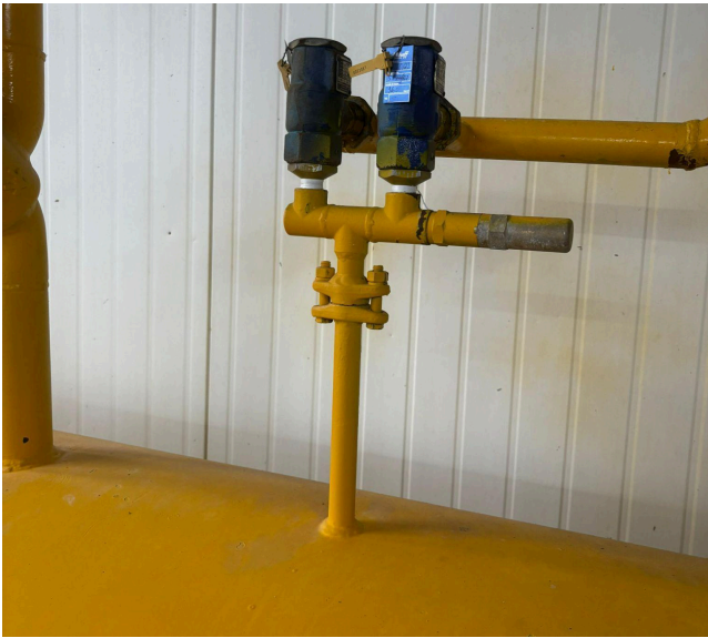
Figura 18. Válvulas de Segurança do tanque de armazenamento.
