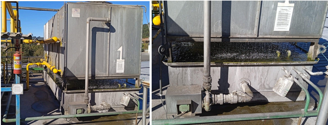
Figura 27. Torre de resfriamento 01.
