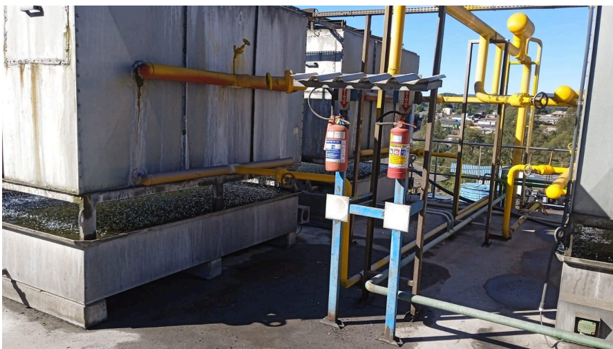
Figura 28. Torres de resfriamento 02 e 03.
