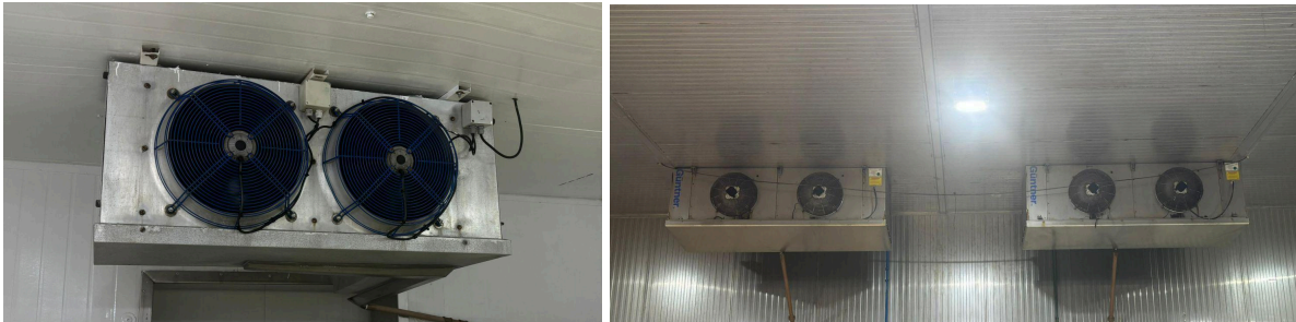
Figura 24. Evaporadores de amônia (forçadores).
