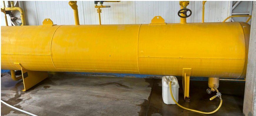
Figura 16. Tanque de armazenamento de amônia.
