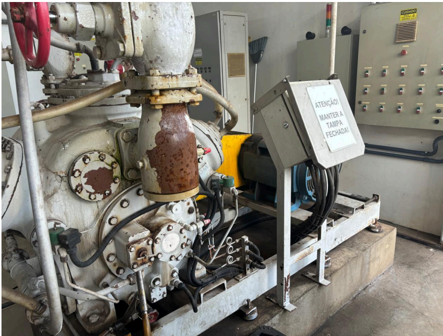
Figura 20. Compressor de amônia 01.
