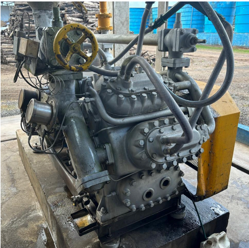
Figura 22. Compressor de amônia 03.
