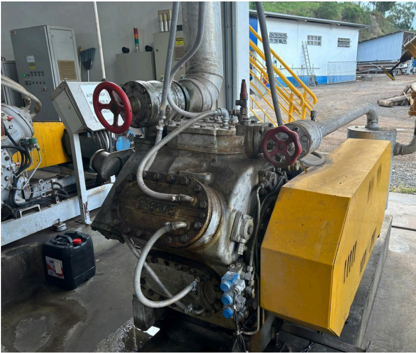
Figura 21. Compressor de amônia 02.
