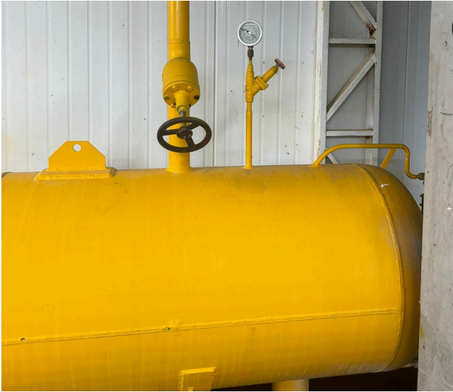
Figura 17. Manômetros do tanque de armazenamento.
