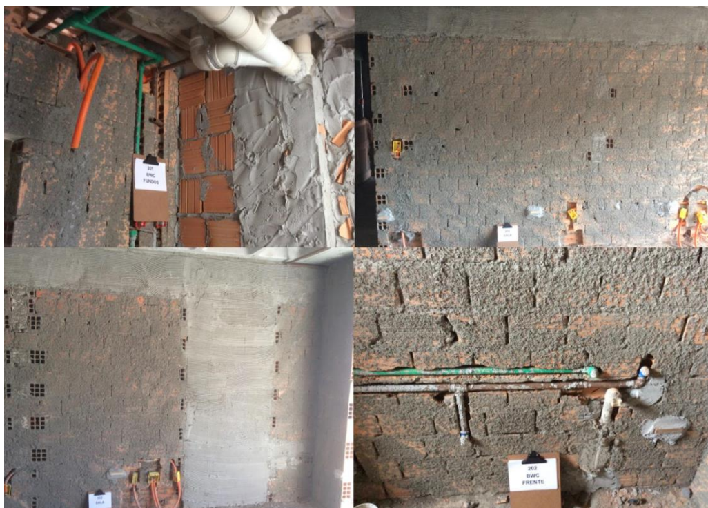
Figura 26 - Fotos das instalações hidrossanitárias
