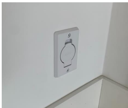
Figura 30 - Dutos para mangueiras
