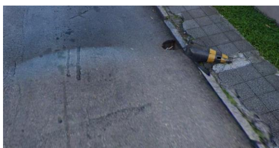
Figura 14 - Buracos na rua (1)
