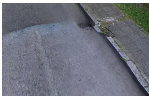
Figura 15 - Buracos na rua (2)
