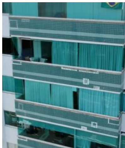
Figura 39- Linhas tracejadas indicando falhas no rejunte
