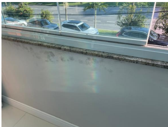
Figura 37- Possíveis marcas de umidade
