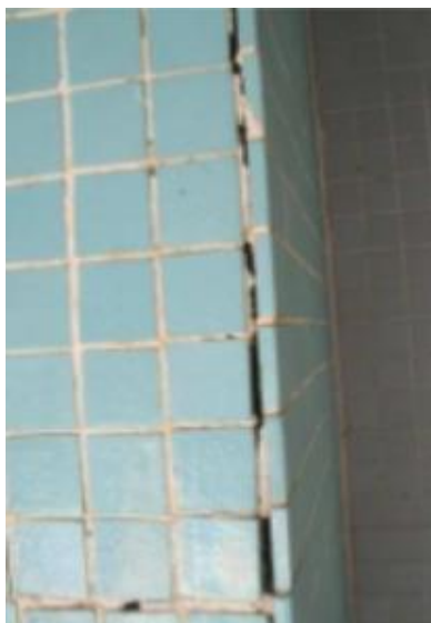
Figura 10- Falha no rejunte
