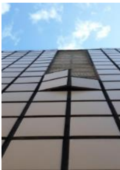
Figura 5- Descolamento do revestimento cerâmico
