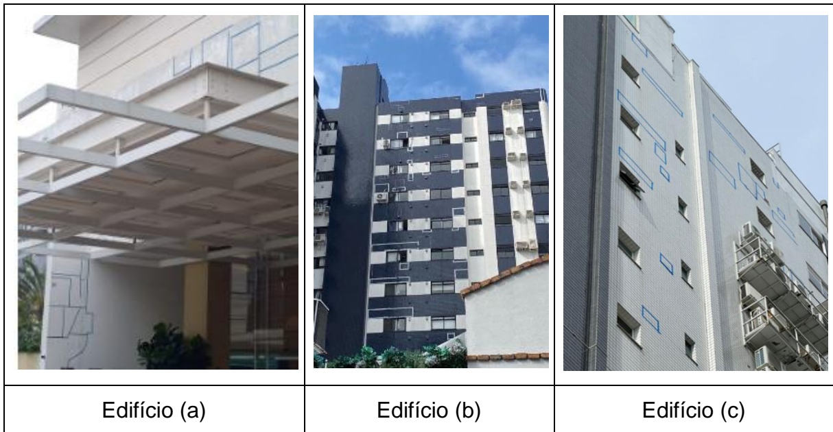
Figura1-Mapeamentos nas fachadas de edifícios localizados na cidade de Florianópolis
