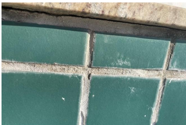
Figura 38- Falha no rejunte
