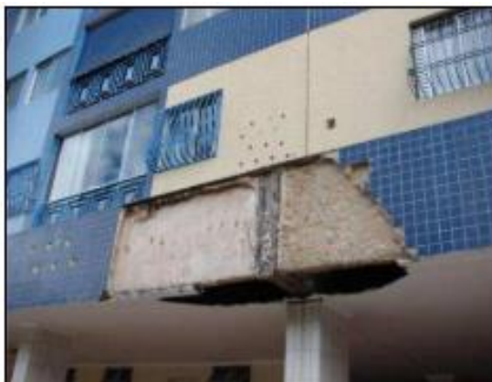
Figura 7- Deslocamento do emboço
