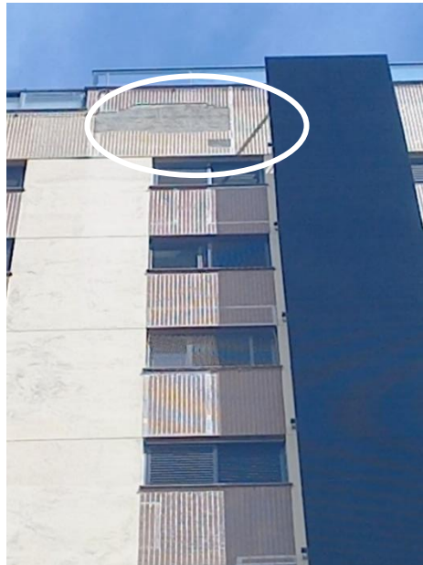
Figura 23- Deslocamento do revestimento cerâmico
