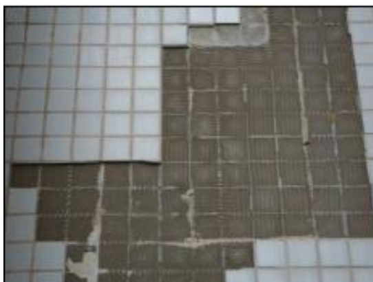
Figura 6- Deslocamento do revestimento cerâmico
