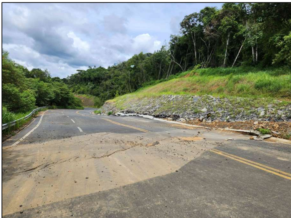
Figura 1 – Trincas na rodovia SC 477 geradas por ruptura de talude
