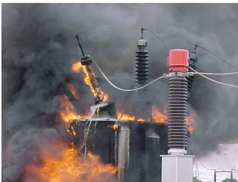
Figura 2.5 – Transformador em chamas após falha de bucha
