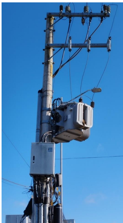
Figura 25 – QGP instado em poste
