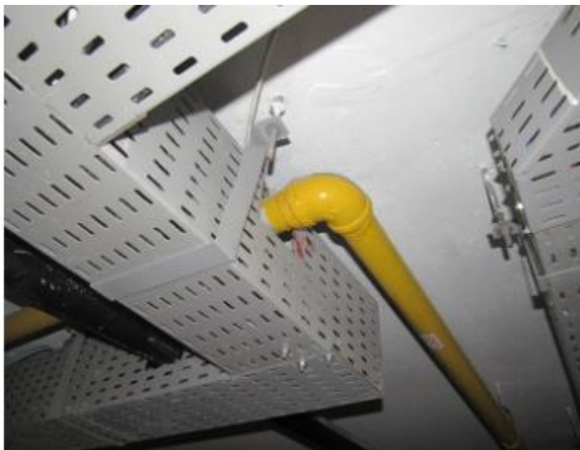
Figura 10 - Falta de compatibilização entre os projetos elétrico e de gás
