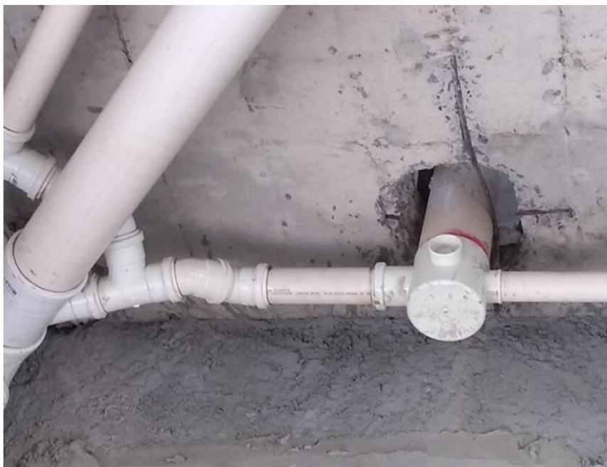
Figura 9 - Interferência de instalação complementar na armadura principal da laje
