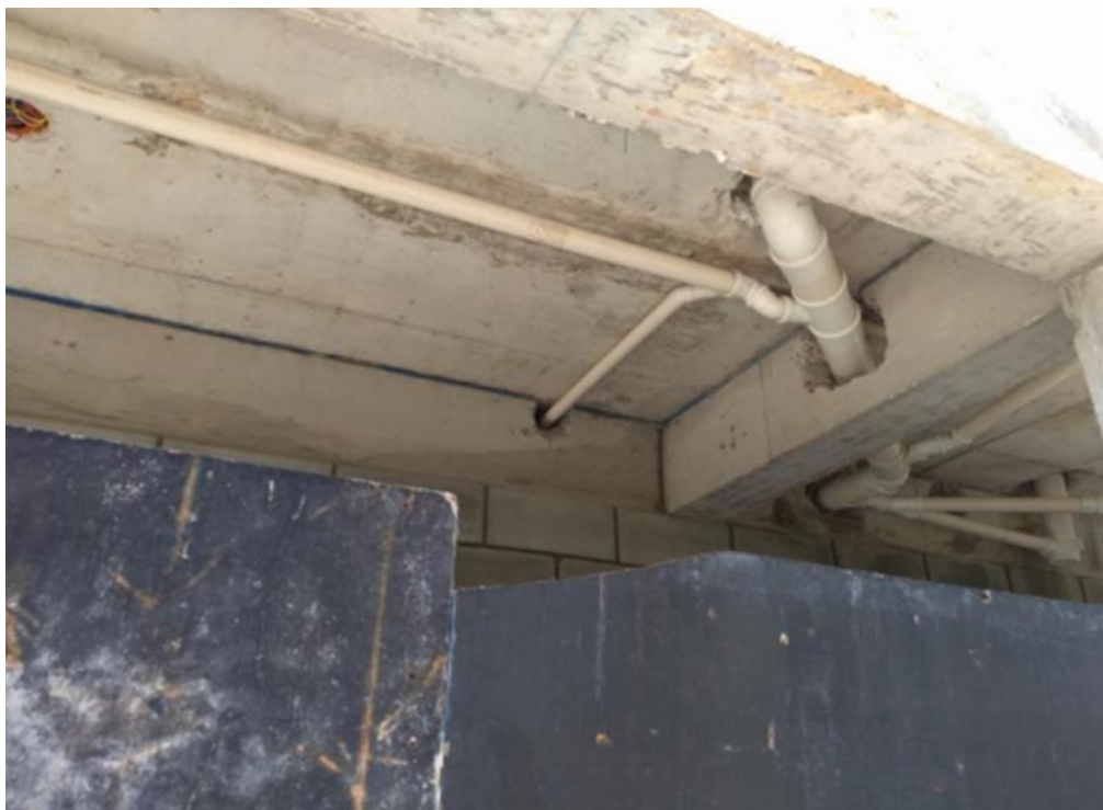
Figura 8 - Instalação hidrossanitária passando por um elemento estrutural
