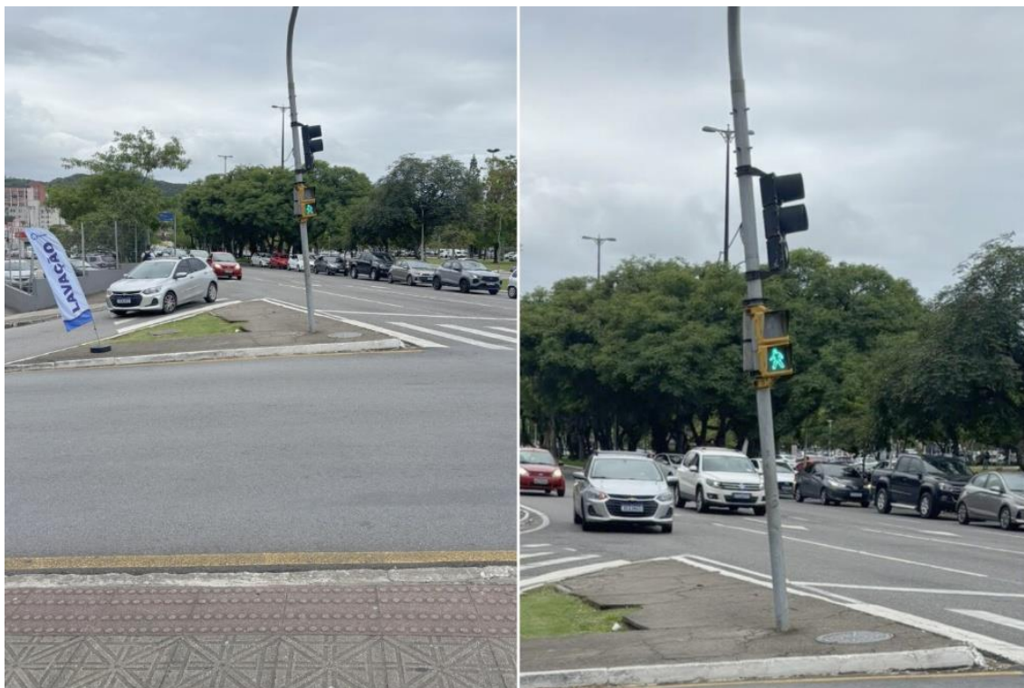
Figura 37 – Ausência de pintura da faixa de pedestres – Trecho T10
