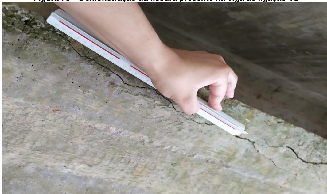
Figura 75 – Demonstração da fissura presente na viga de ligação V1
