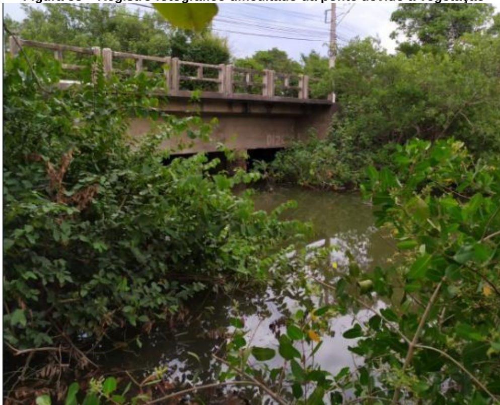
Figura 55 – Registro fotográfico dificultado da ponte devido a vegetação
