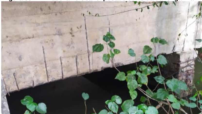
Figura 85 – Armadura vertical exposta e corroída da longarina L1
