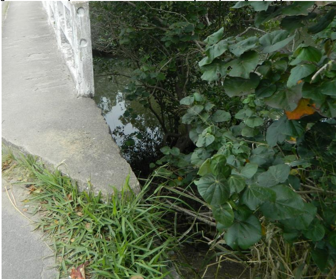
Figura 54 – Obstrução do acesso ao outro lado da ponte por vegetação, pedras e animais
