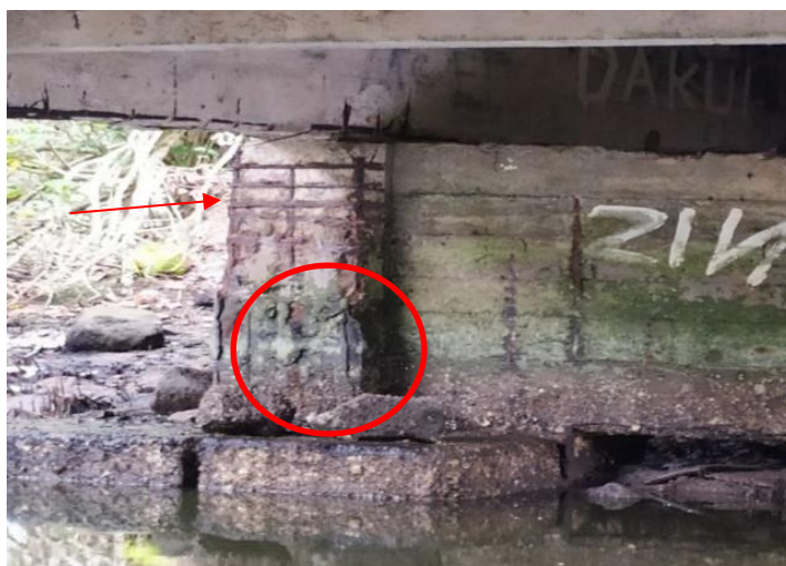
Figura 70 – Corrosão e deterioração do pilar P4
