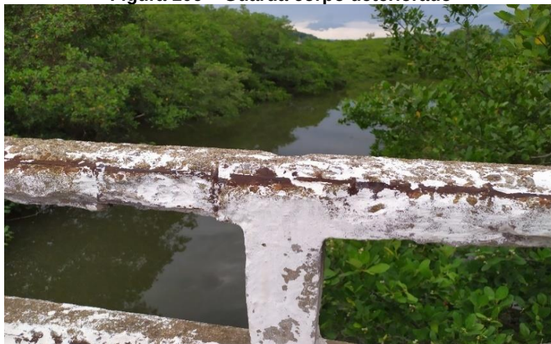
Figura 106 – Guarda corpo deteriorado
