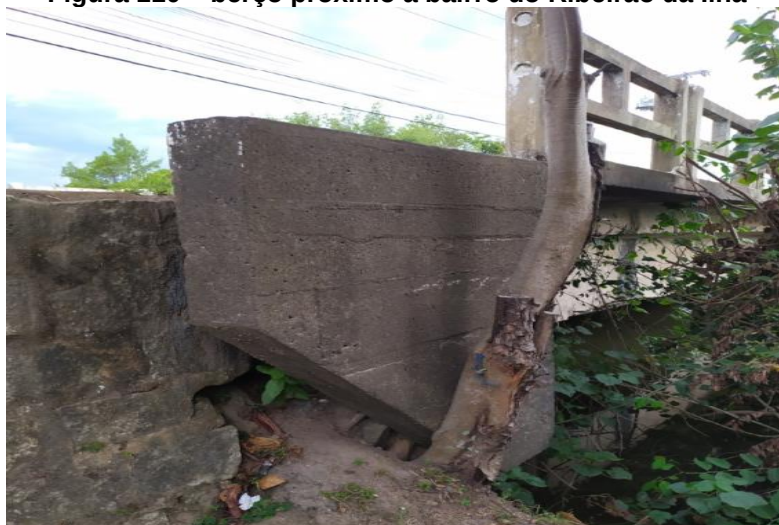
Figura 110 – berço próximo a bairro do Ribeirão da Ilha
