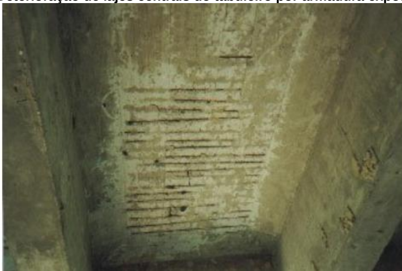
Figura 36 – Deterioração de lajes centrais do tabuleiro por armadura exposta e oxidada.
