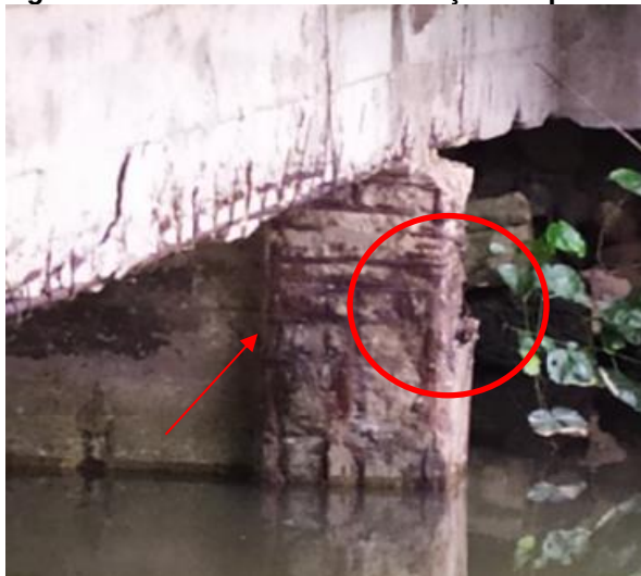
Figura 68 – Corrosão e deterioração do pilar P2
