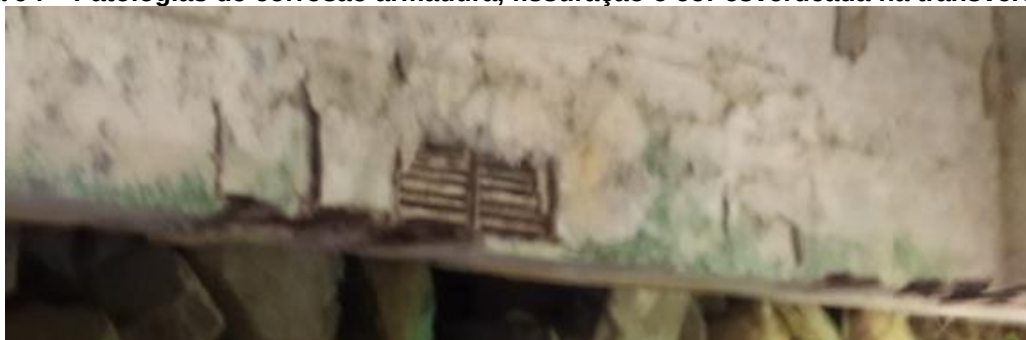
Figura 94 – Patologias de corrosão armadura, fissuração e cor esverdeada na transversina T1
