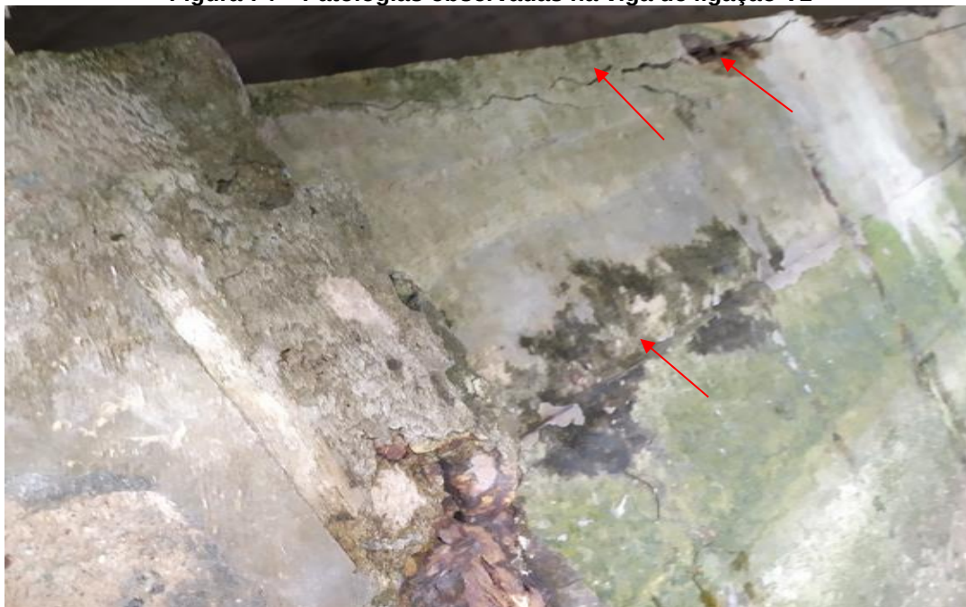
Figura 74 – Patologias observadas na viga de ligação V1
