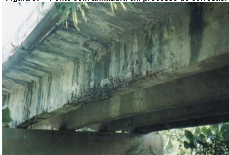
Figura 37 – Ponte com armadura em processo de corrosão.
