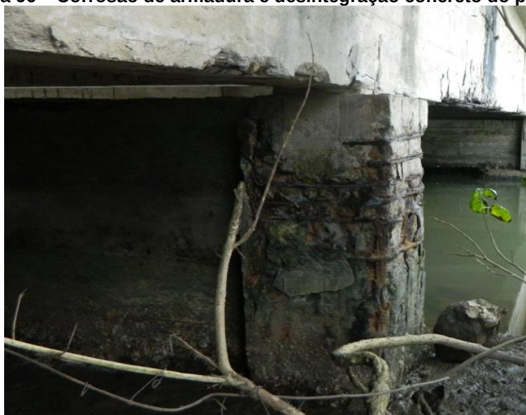
Figura 66 – Corrosão de armadura e desintegração concreto do pilar P1
