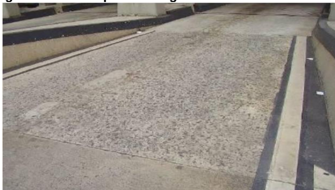
Figura 30 – Exemplo de desgaste abrasivo em concreto.
