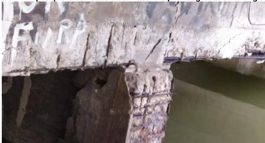
Figura 87 – Exposição e corrosão da armadura e pilar degradado na longarina L2
