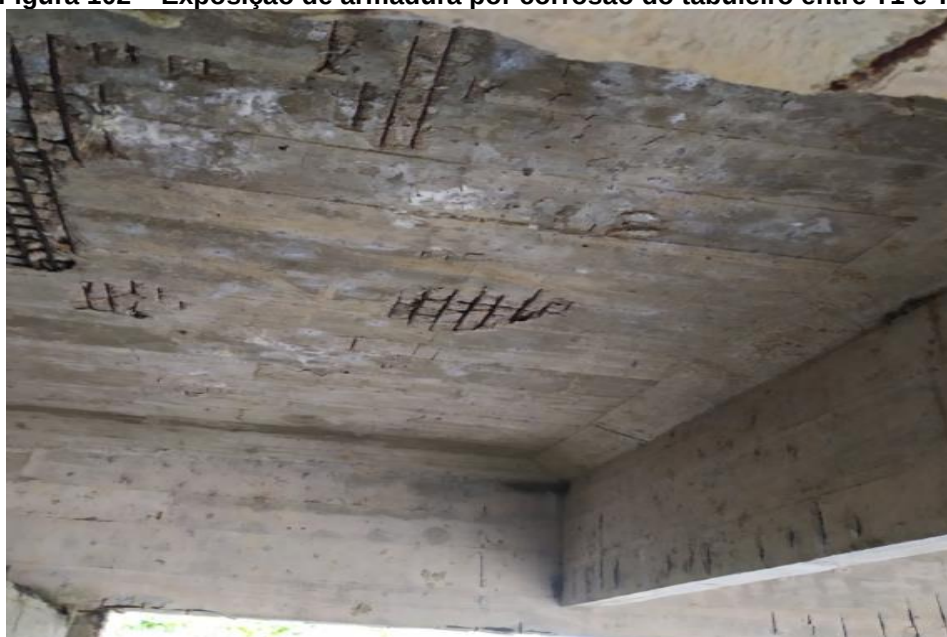
Figura 102 – Exposição de armadura por corrosão do tabuleiro entre T1 e T2
