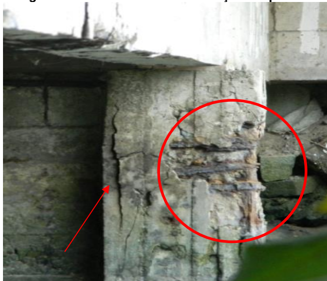
Figura 69 – Corrosão e deterioração do pilar P3
