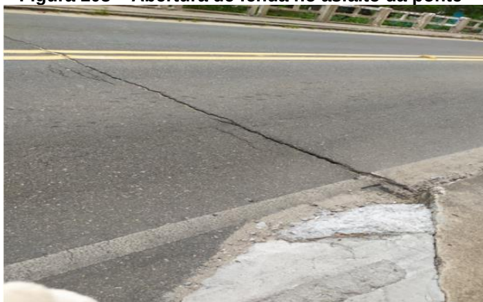
Figura 108 – Abertura de fenda no asfalto da ponte
