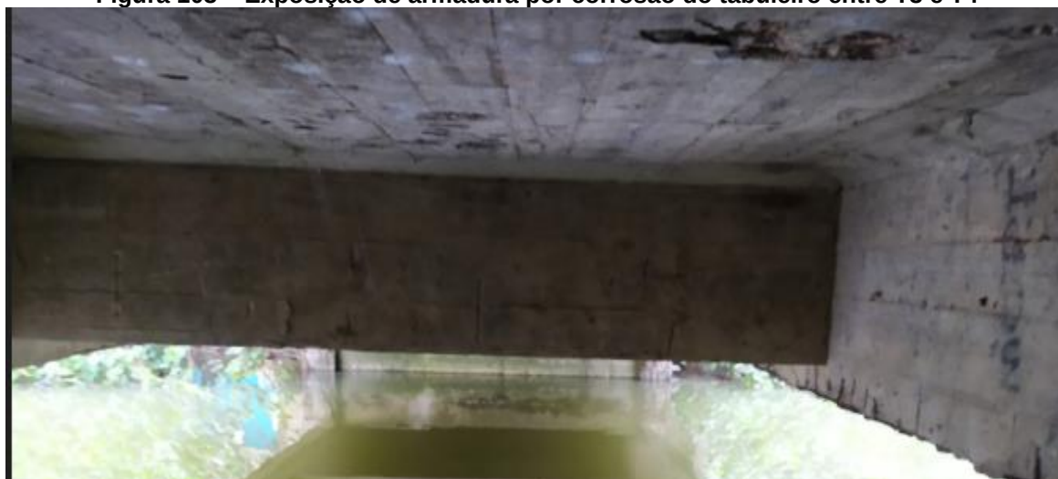
Figura 103 – Exposição de armadura por corrosão do tabuleiro entre T3 e T4
