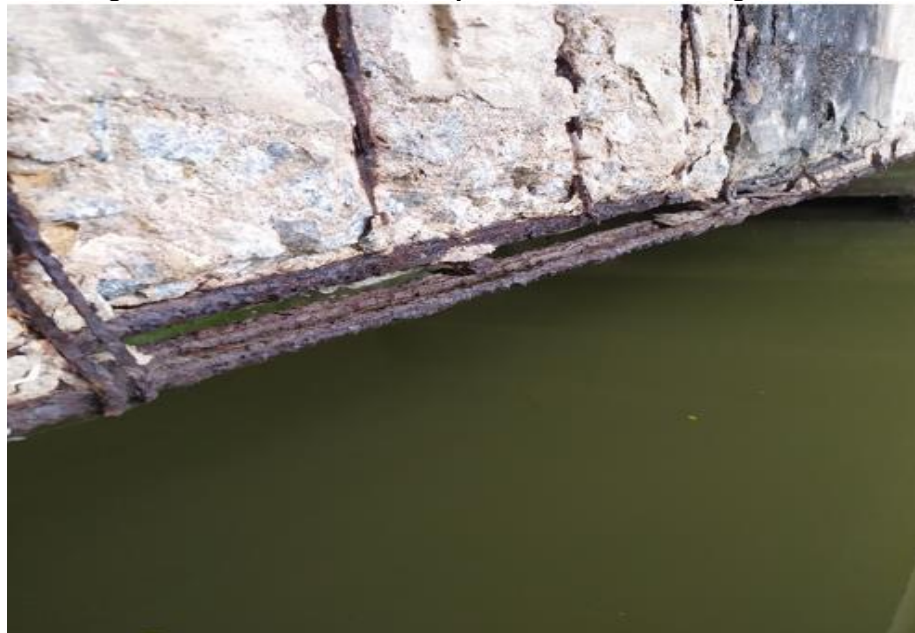
Figura 84 – Armadura sem capa de concreto da longarina L1
