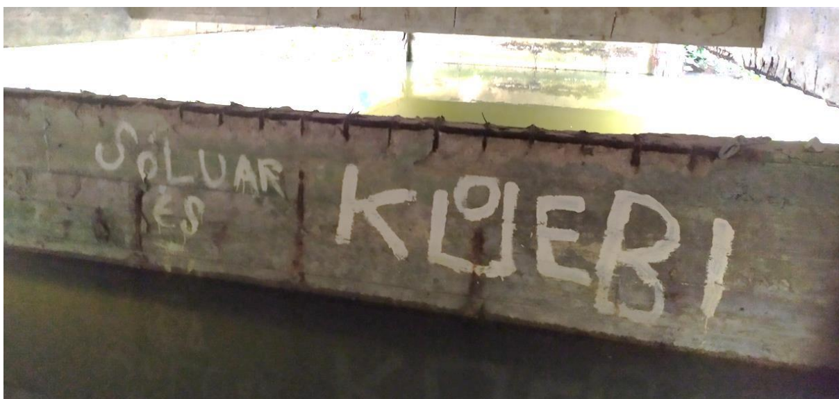
Figura 77 – Exposição de armadura presente na viga V2
