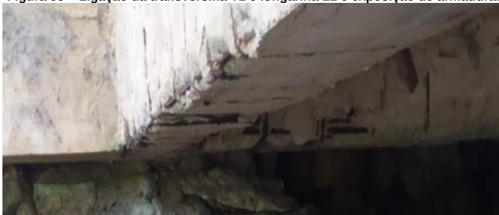
Figura 95 – Ligação da transversina T1 e longarina L1 e exposição de armadura.
