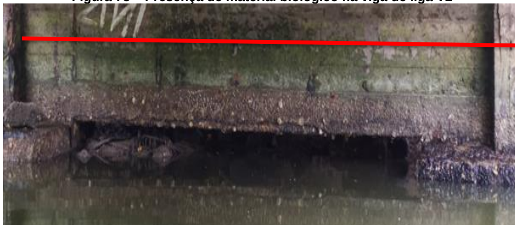
Figura 78 – Presença de material biológico na viga de liga V2
