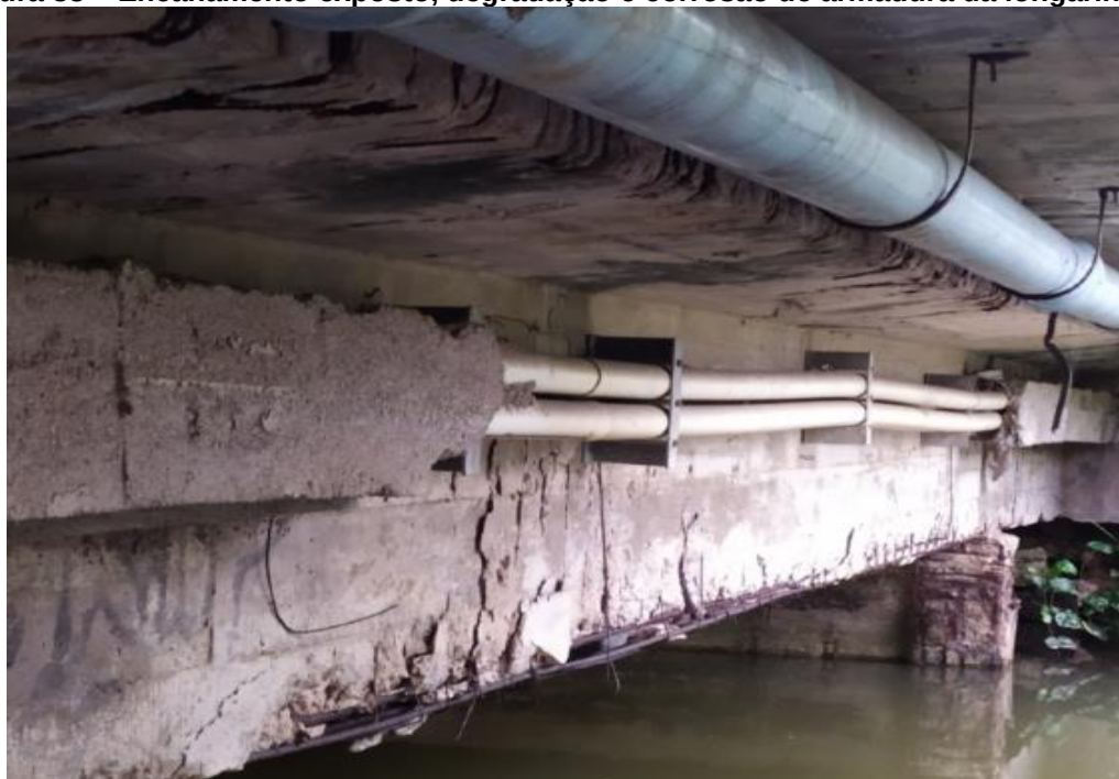
Figura 88 – Encanamento exposto, degradação e corrosão de armadura da longarina L2
