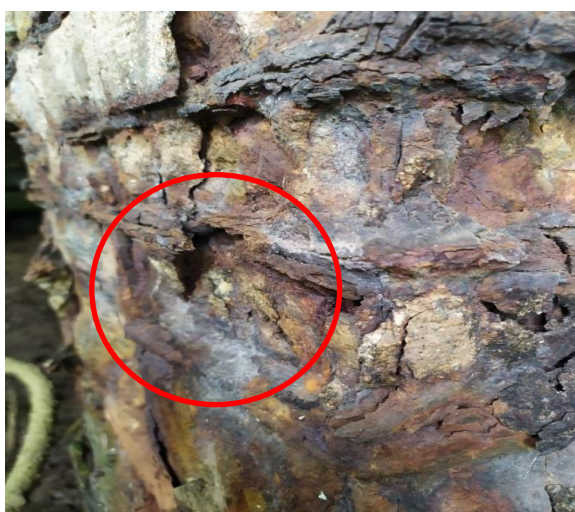
Figura 67 – Corrosão e rompimento de armadura do pilar P1
