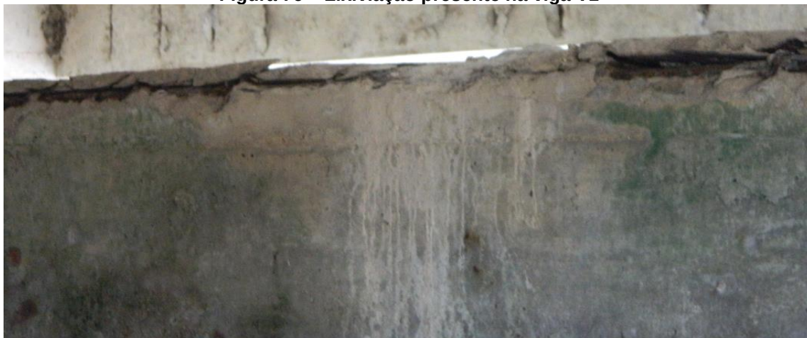
Figura 76 – Lixiviação presente na viga V1
