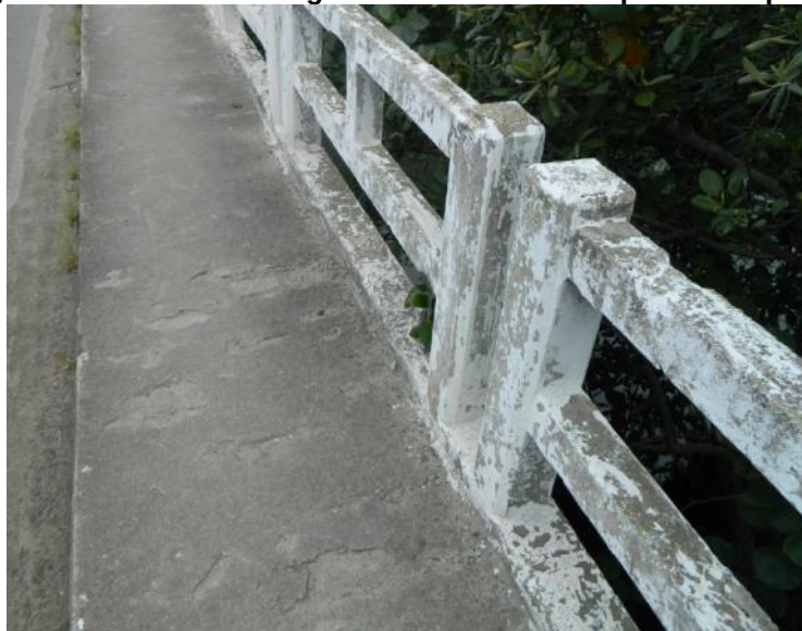
Figura 107 – Passeio desgastado devido ao tempo e intempéries
