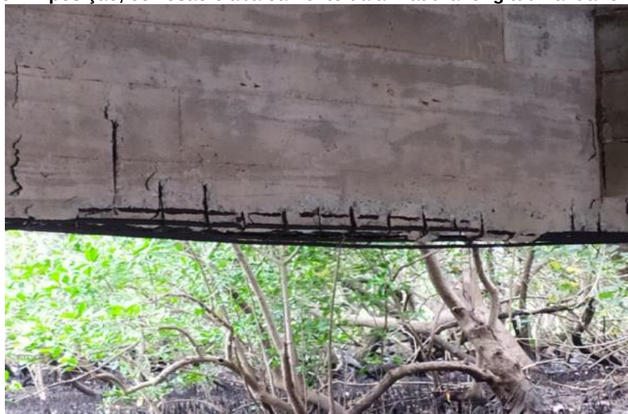
Figura 86 –Exposição, corrosão e abaloamento da armadura longitudinal da longarina L2
