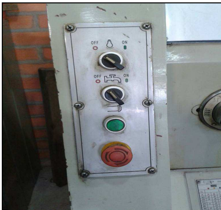
Figura 21 - Botoneira de emergência sem identificação
