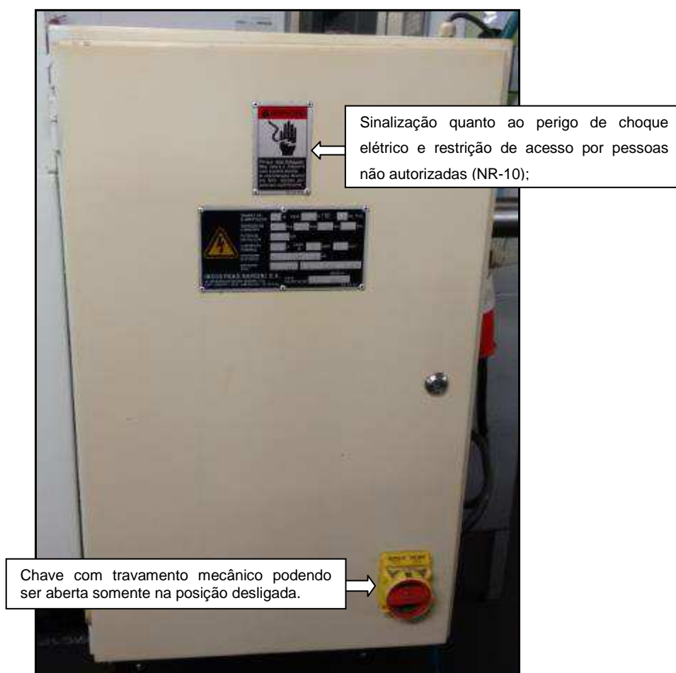
Figura 20 - Painel elétrico identificado.
