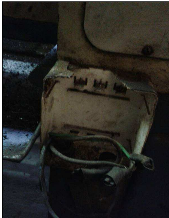
Figura 6 - Fios elétricos mal encapados com risco de choque elétrico, presentes na parte externa do Torno.
