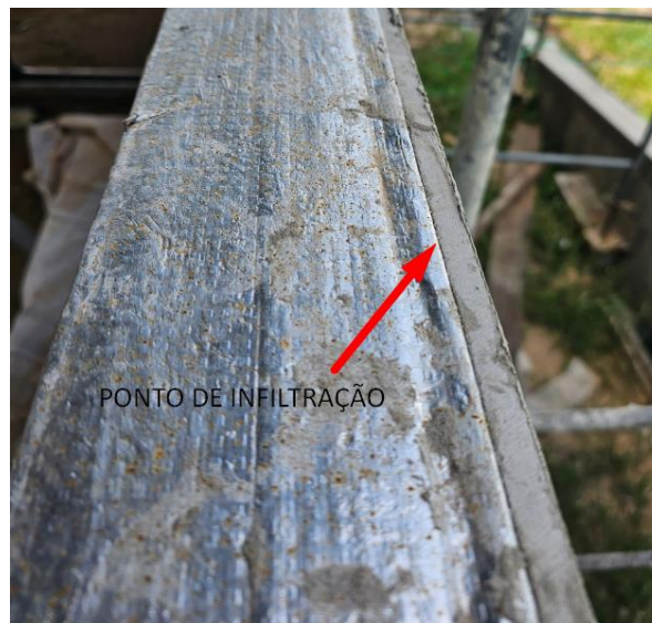
Figura 16 – Possível ponto de infiltração entre estrutura e placa cimentícia
