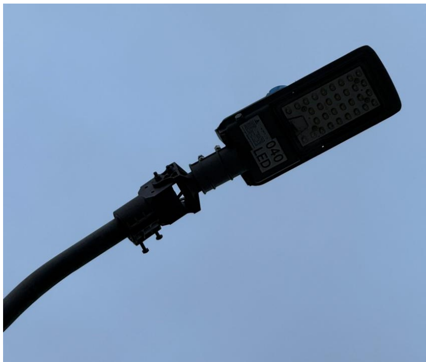
Figura 15 – Luminária de 40 W na Rua Antônio Victor Gonçalves.
