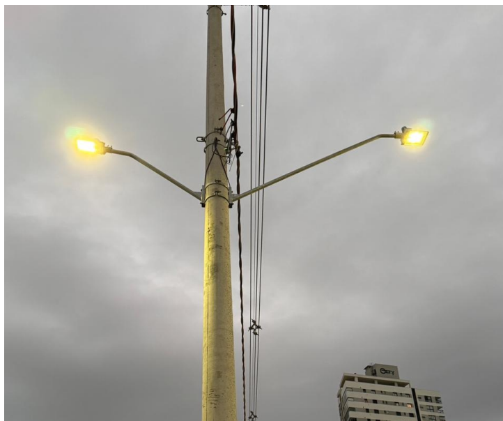
Figura 10 – Poste com os pontos de iluminação na Av. Marcos Konder.
