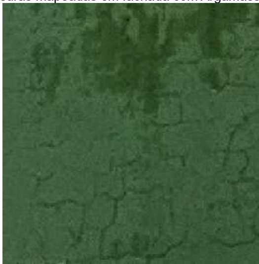
Figura 01 – Presença de fissuras mapeadas em fachada com Argamassa com hidratação controlada
