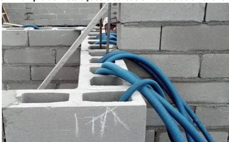
Figura 05 - Exemplo de instalações elétricas em obras de alvenaria estrutural
