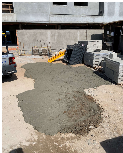
Figura 14: Desperdício de concreto ao fim da concretagem.
