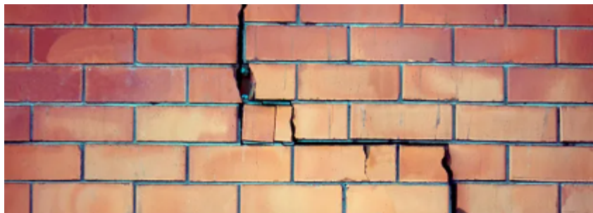
Figura 04: Trinca em alvenaria
