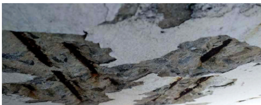
Figura 03: Corrosão de armaduras
