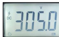
Fig. 14. Medição da tensão de barramento CC do inversor modular
