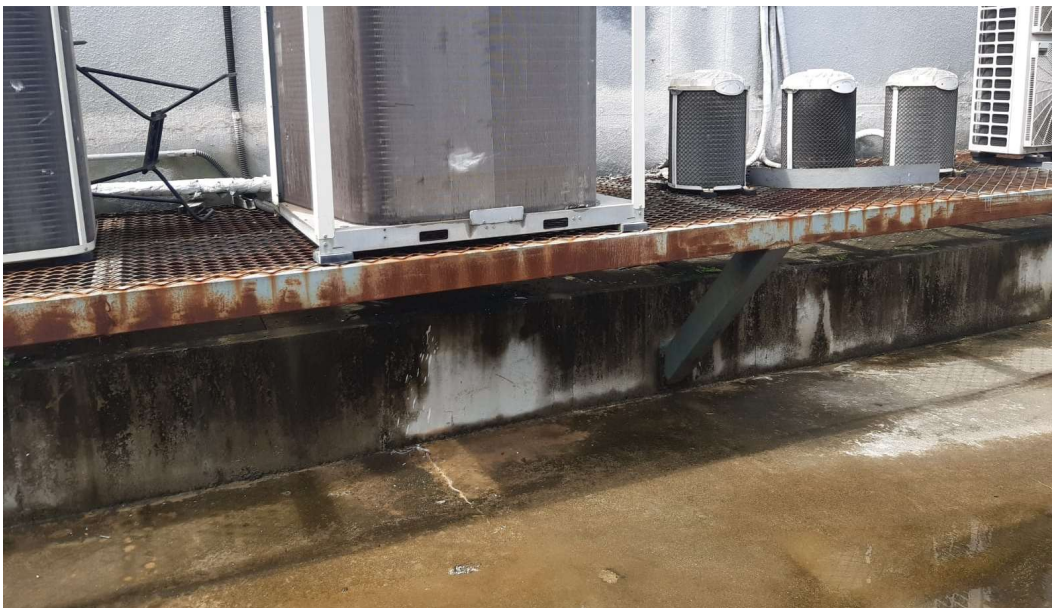
Quadro 25 - Avaliação de manifestação patológica – Corrosão de estrutura metálica
