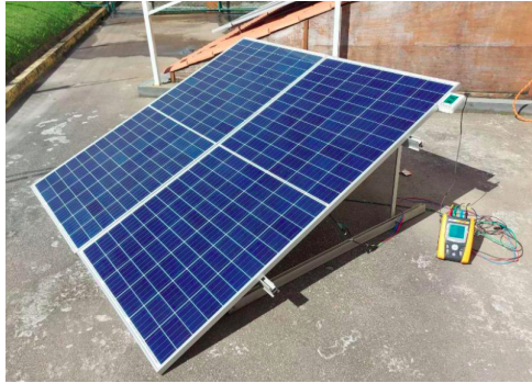
(a) Medição dos módulos usando PV-Check
