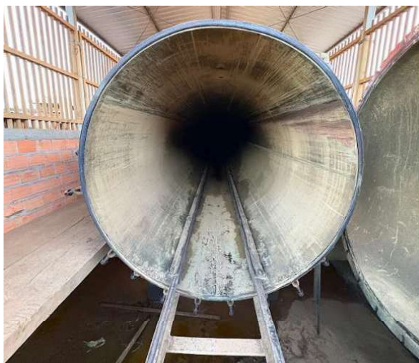
Figura 22 - Porta da autoclave da Empresa A
