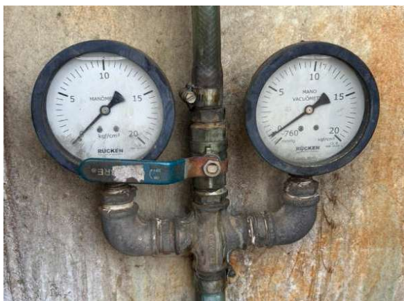
Figura 24 - Instrumentos utilizados para controle de vácuo e pressão.
