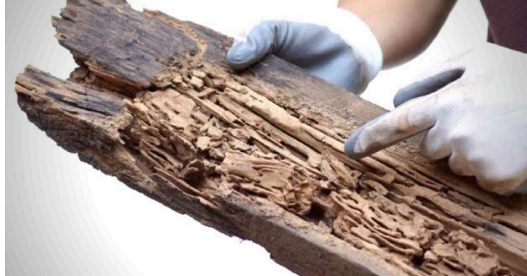
Figura 5 - Madeira severamente atacada por cupins
