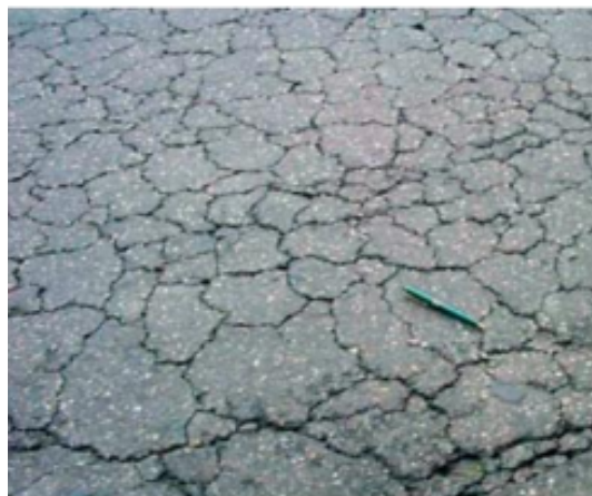
Figura 08 – Defeito de Fadiga na superfície do Pavimento
