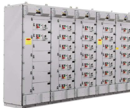
Fig. 4. Centro de controle de motores (CCM). Fonte: [14].
