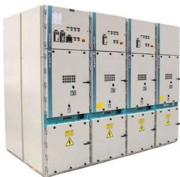
Fig. 3. Cubículo de média tensão. Fonte: [14].
