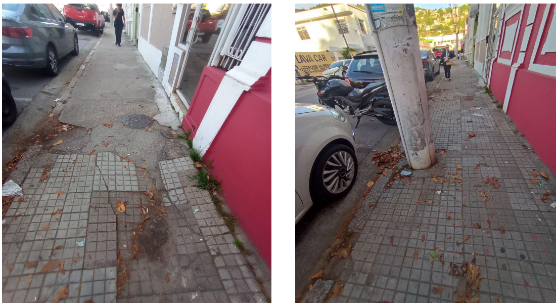
Figura 33 - Buraco e poste na calçada da Rua Hermann Blumenau
