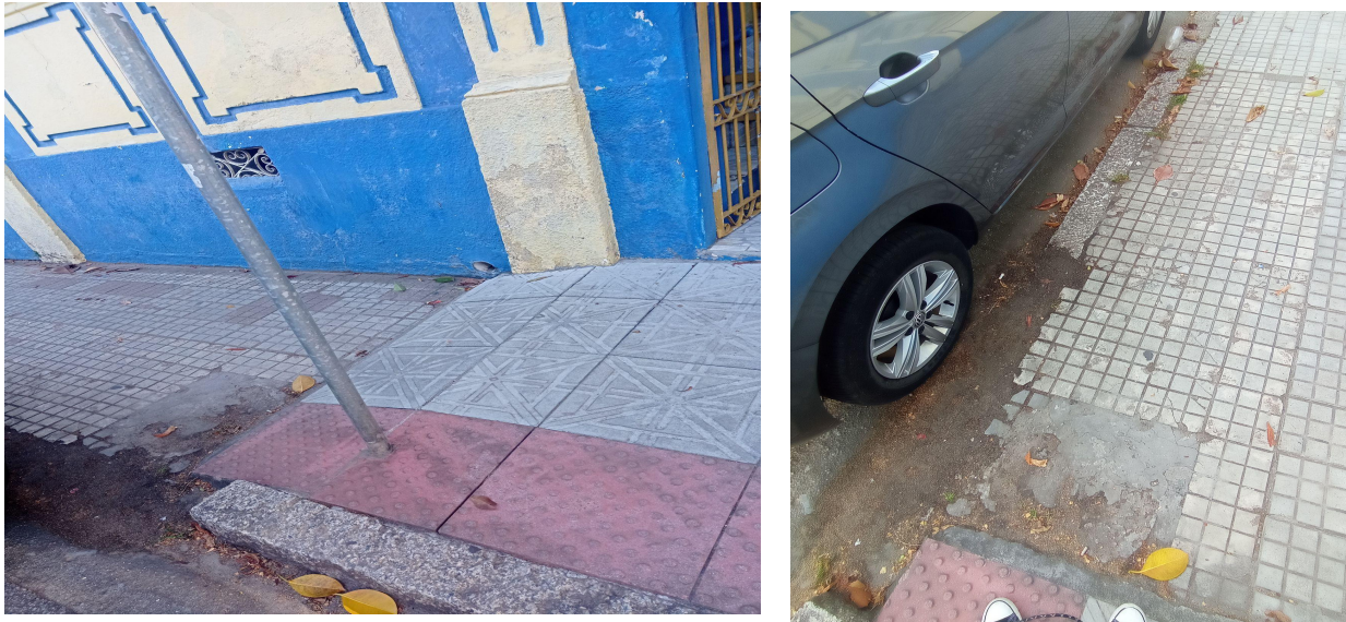
Figura 32 - Estado da calçada da Rua Hermann Blumenau
