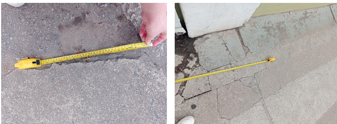
Figura 62 - Medição de buracos na calçada
