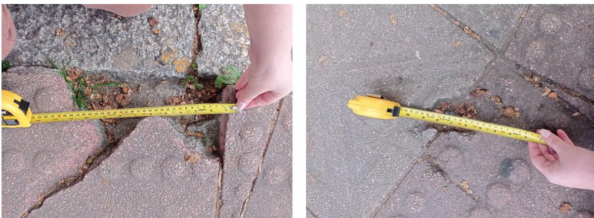
Figura 60 - Medição de buraco na calçada
