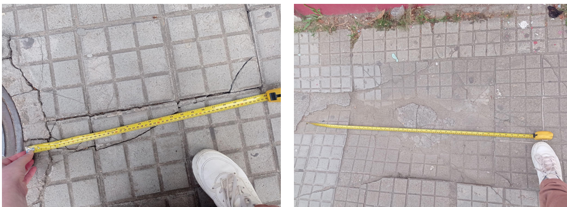
Figura 61 - Medição de buraco / rachadura na calçada
