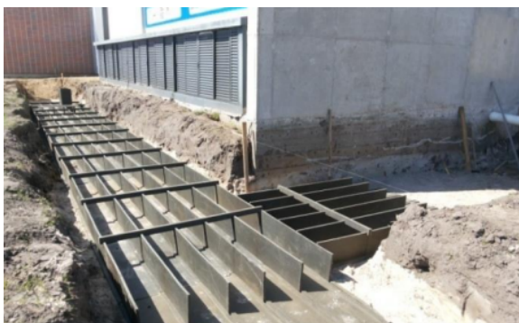
Figura 12 - Visão geral do sistema montado.
