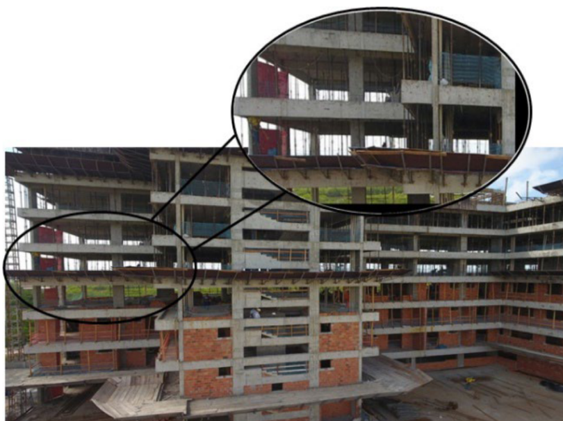
Figura 04 — Vão aberto sem guarda-corpo.
