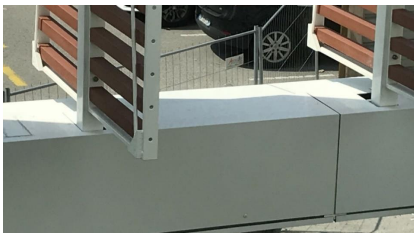
Figura 53 – Peça faltante de fachada logo abaixo do brise
